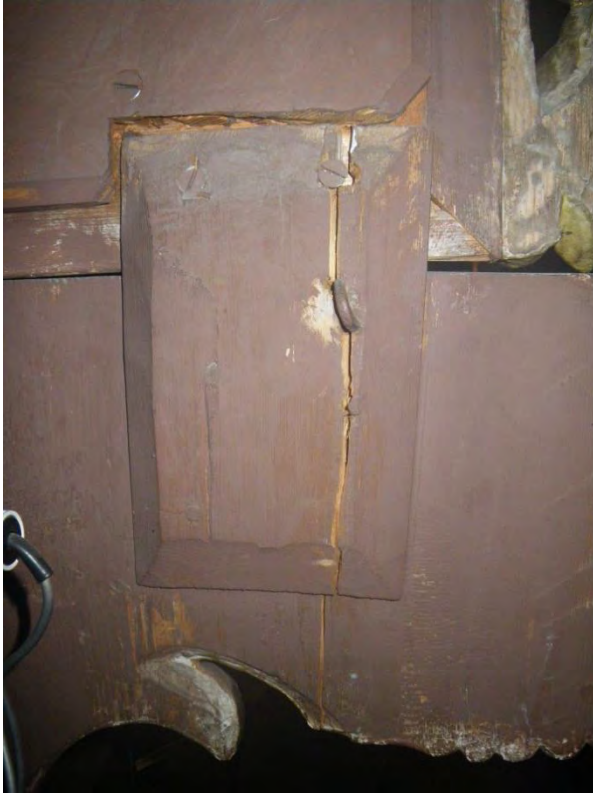
Figure 2 Skada för restaurering al retro.
