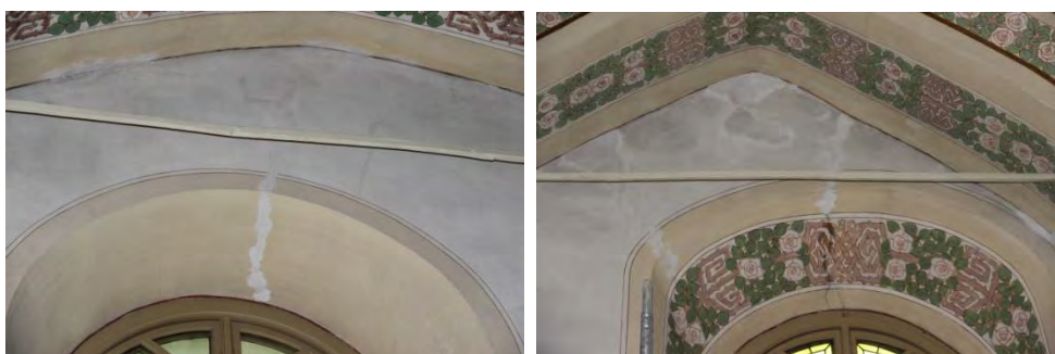
Bilderna visar spricklagningar. Foto: Kristina ka 20120918_0048 och 0047.
