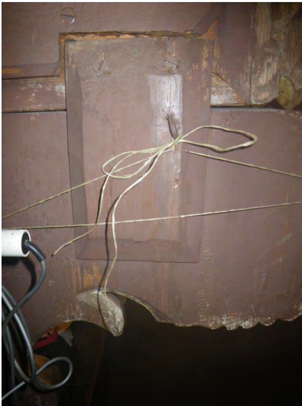
Figure 5 Skada baktill efter restaurering.
