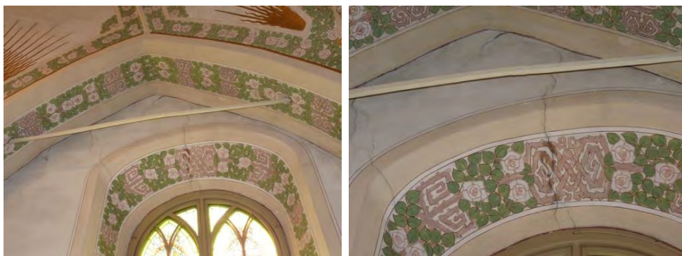
Bilderna visar sprickor i putsen över fönstren. Foto: KM12078 Kristina ka 20120619_11 och 12 av Helén Sjökvist.
