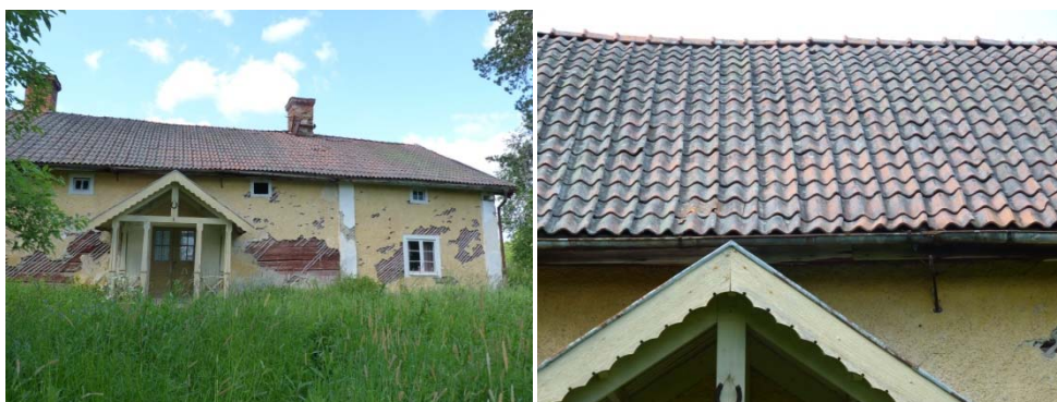
Figur 33. Östra takfallet är till synes i bättre kondition än västra takfallet. Foto: Helén Sjökvist.
