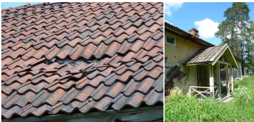
Figur 22. Närbild av takskada, där man även tycks skymta undertaket av näver. Foto: Helén Sjökvist.
