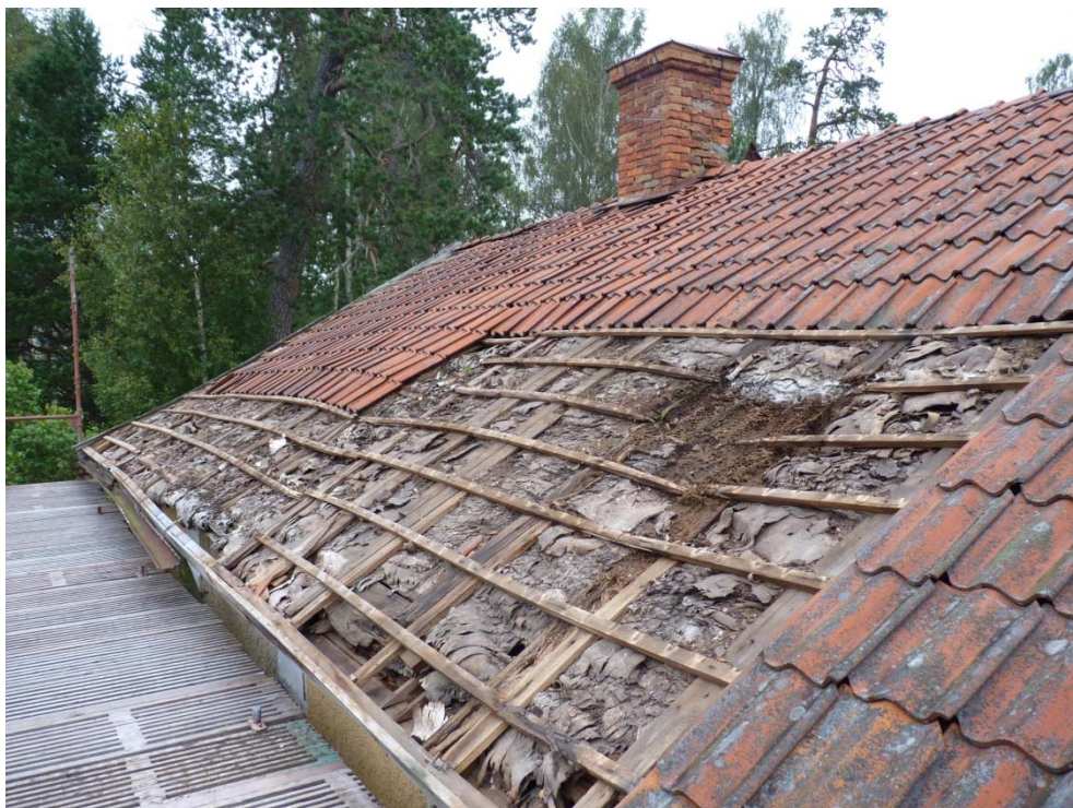
Figur 28. Västra takfallet sett mot norr. Strax till höger om mitten syns ett ställe där takläckaget gått igenom läket, näver och skadat undertaket. Norra skorstenen är i något bättre skick än den södra. Räcker troligen med omfogning. Foto: Helén Sjökvist.
