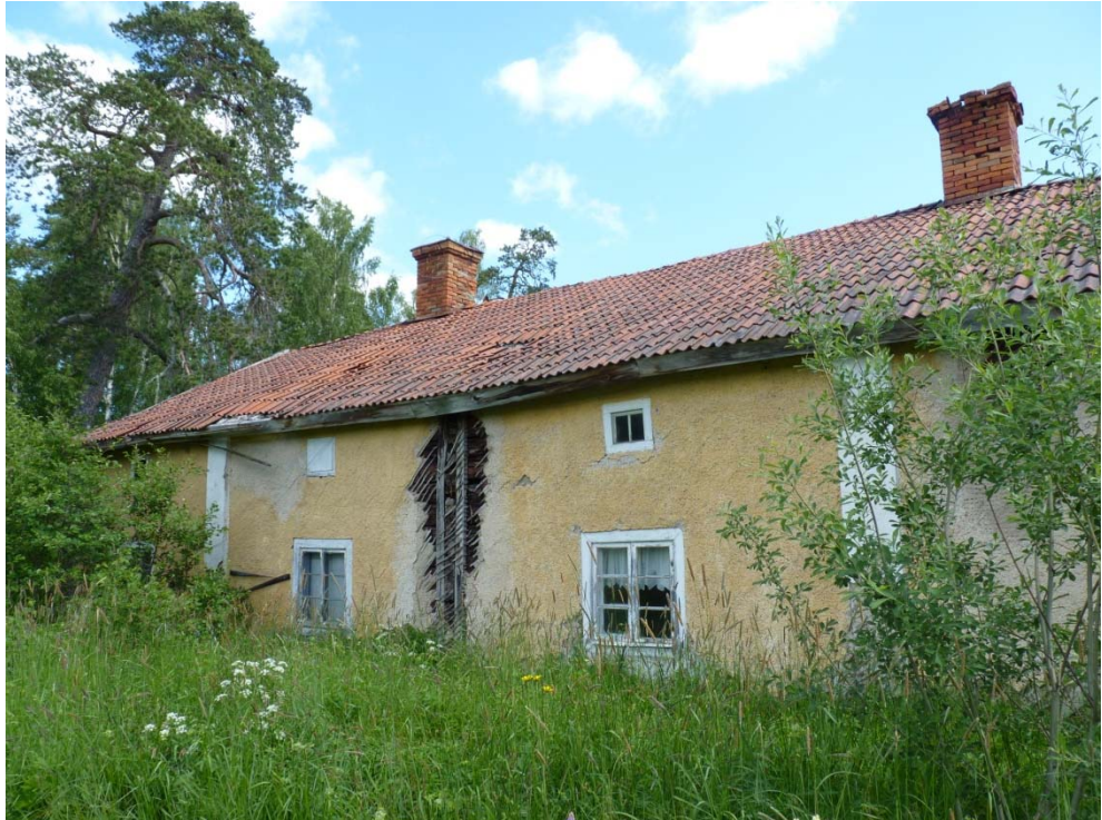
Figur 8. Byggnadens västra fasad. Vid den mittersta knuten har ett takläckage lett till rötskador i timret och putsbortfall. Foto: Helén Sjökvist.
