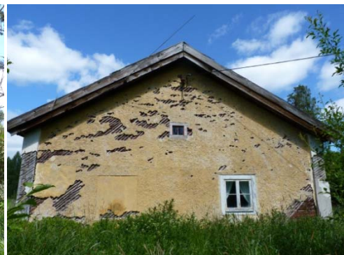
Figur 12. Södra gaveln med större putsbortfall. Foto: Helén Sjökvist.
