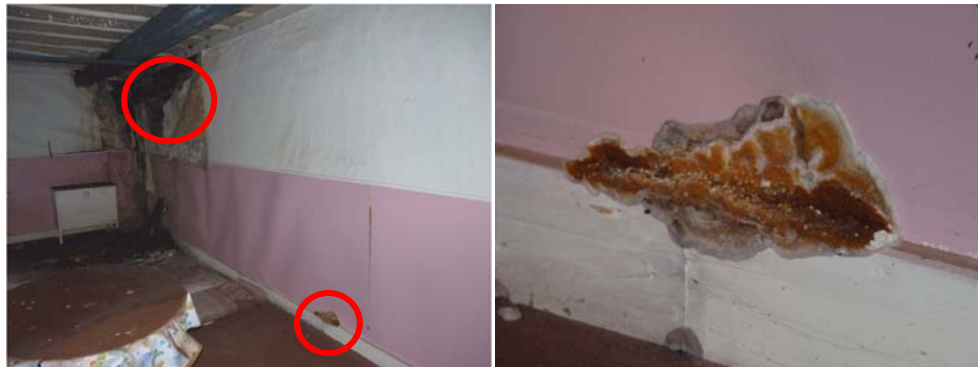
Figur 37. Vägg, mitt i byggnaden, som drabbats värst av takläckaget. Här kunde hussvampsangreppet först lokaliserats (Längst bort till vänster syns västra ytterväggen och till höger innerväggen). Den övre ringen markerar synligt svampmycel, se bild nedan, och den nedre ringen markerar en svampkropp som kommer fram under listen och upp på väggen. Foto: Helén Sjökvist. Figur 38. Närbild på den först lokaliserade synliga hussvampskroppen. Foto: Helén Sjökvist.
