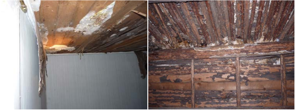
Figur 47. Ett omfattande svampangrepp uppdagades i taket i byggnadens södra del då takpappen revs ned. Foto: Helén Sjökvist.
