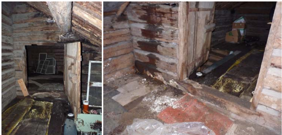
Figur 49. Svampangripen tröskel/bjälke vindens norra del. Sedd mot norr. Foto: Helén Sjökvist.
