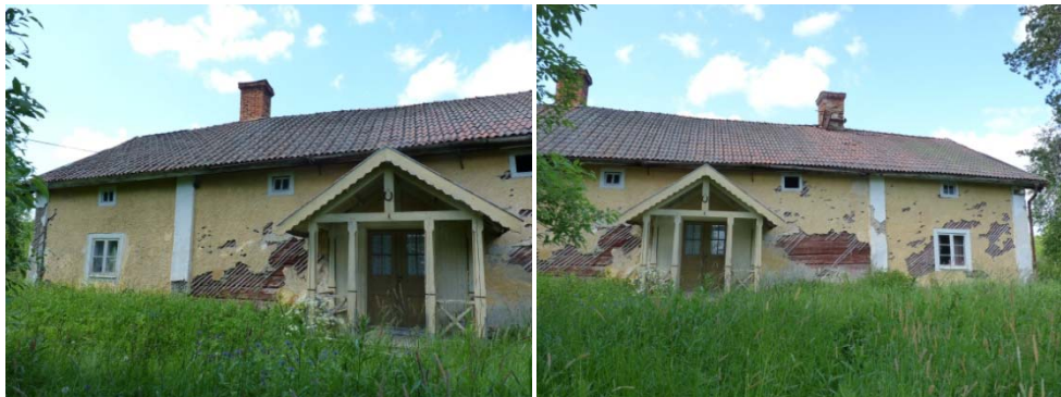
Figur 9 och 10. Entrén finns på den östra fasaden. Vissa putsbortfall finns även där men skadorna i stommen är inte av samma allvarliga art. Foto: Helén Sjökvist.
