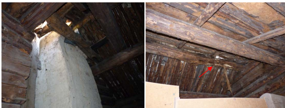
Figur 26. Antäckning saknas eller är mycket bristfällig kring den ena skorstenen. Foto: Helén Sjökvist.
