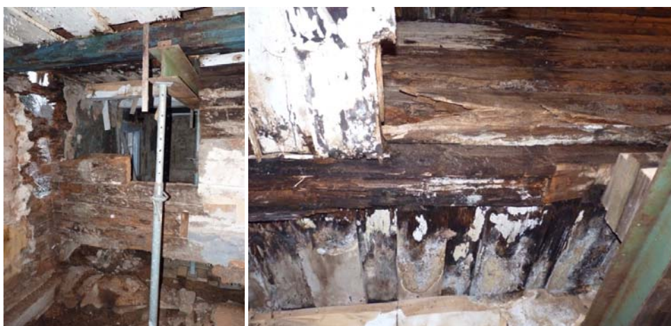
Figur 43. Delar av mellanväggen med svampangrepp är borttagen. Sedd mot norr. Relativt kraftig stengrund under mellanväggen. Foto: Helén Sjökvist.
