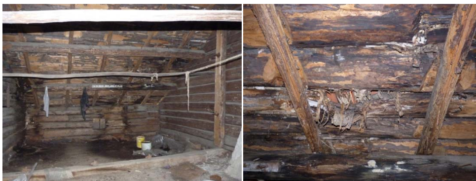
Figur 24 och 25. Exempel på takläckage sett från vinden. Foto: Helén Sjökvist.
