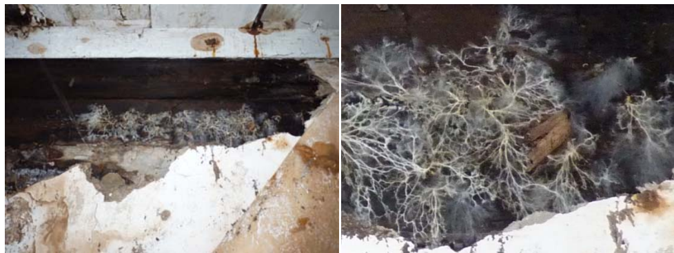
Figur 39. Svampmycel på väggen, delvis dold av lerklining. Till höger syns den p.g.a. fukten nedfallna pappspänningen. Bakomliggande timmer är i dålig kondition. Foto: Helén Sjökvist. Figur 40. Närbild av svampmycel. Foto: Helén Sjökvist.
