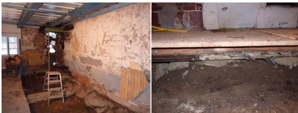
Figur 41. Rummet söder om den rivna mellanväggen. Golvet delvis upptaget. Rötskadorna har gjort att det uppstått stora hål i ytterväggen där denna varit sammantimrad med mellanväggen. Sedd mot nordväst. Foto: Helén Sjökvist.
