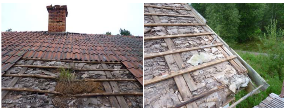
Figur 29. Ytterligare ett ställe på västra takfallet, nedanför den södra skorstenen, där takläckaget gått igenom takets konstruktion. Foto: Helén Sjökvist.
