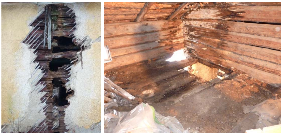
Figur 51. Hål i ytterväggen som uppkommit vid partiell rivning av intimerad mellanvägg. Foto: Helén Sjökvist.
