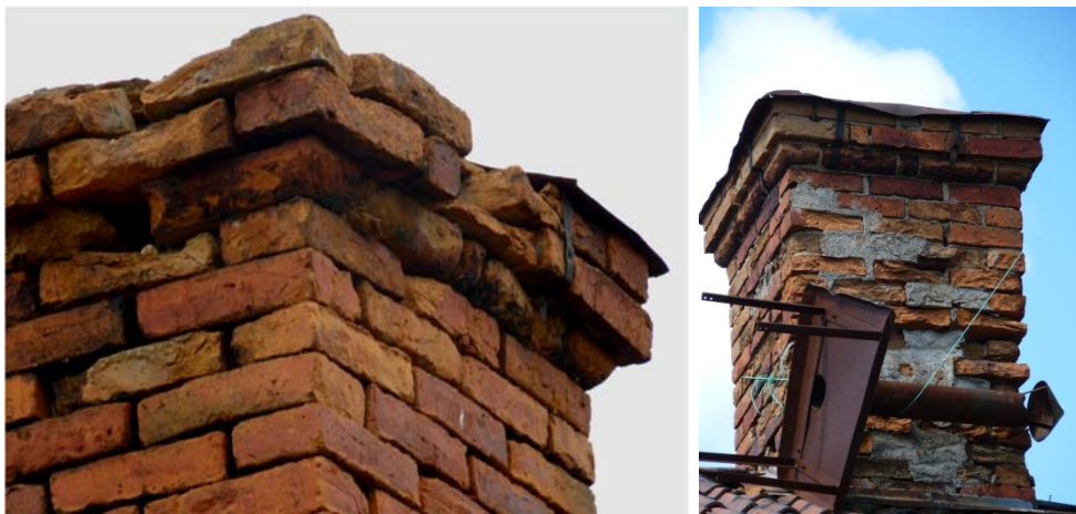
Figur 31. Detalj av den södra skorstenens krönparti. Teglet är skadat och plåtavtäckningen är till större delen borta. Det är osäkert om den rundade delen av frisen är av hugget eller formslaget tegel. Foto: Helén Sjökvist.
