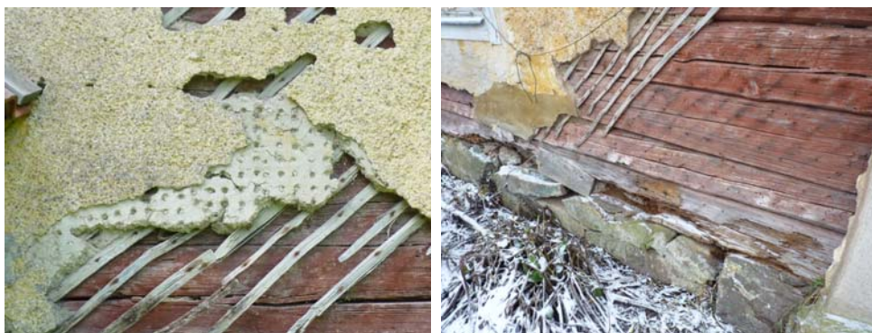
Figur 13. Reveteringen är uppbyggd med en underliggande lerklining fäst på diagonalspikade smala ribbor och därefter en kalkputs. Underst syns det röda timret. Foto: Helén Sjökvist.
