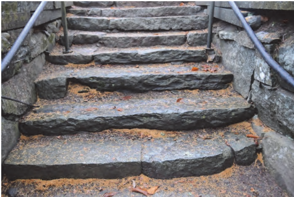
Figur 71. Trappans steg före åtgärder. Foto: Svensk Klimatstyrning.
