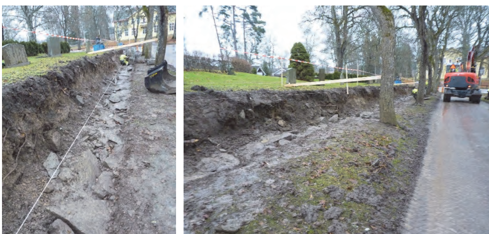
Figur 25. Den befintliga grundläggningen för södra muren ligger kvar orörd. Foto: Helén Sjökvist. Figur 26. Södra muren under omläggning. Foto: Helén Sjökvist.
