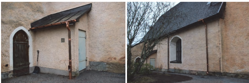
Figur 32. Ny hängränna och stuprör på utbyggnad. Här leds regnvattnet direkt ned till dagvattenanledningen. Foto: Lisa Skanser.
