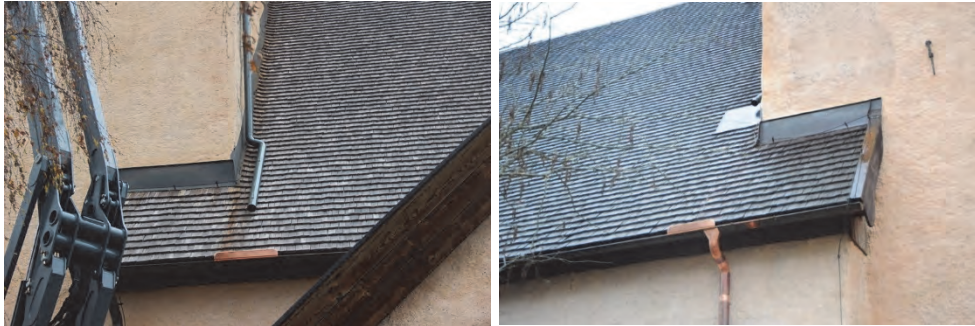
Figur 29. Förkastat förslag till anslutning av tornets stuprör till långhusets hängränna. Foto: Lisa Skanser.
