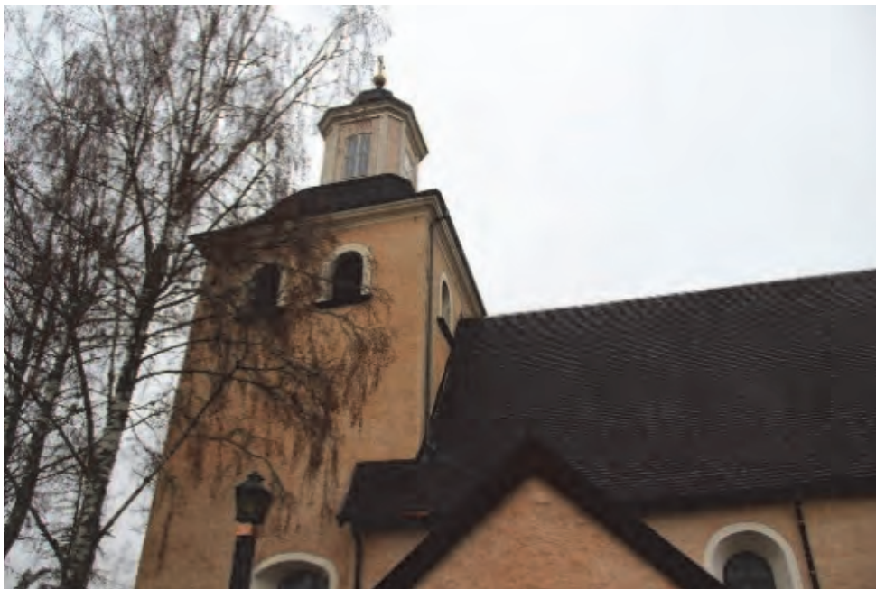
Figur 31. Nyttillkomna stuprör på tornet. Foto: Lisa Skanser.
