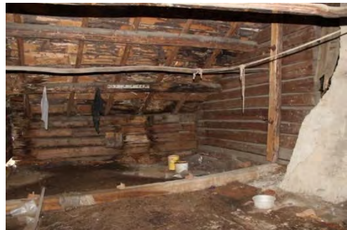
13118_243. Rum 205, foto mot väster. I bilden syns den längsgående bjälken på golvet och den norra väggens förstärkning.
