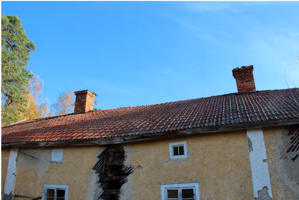
13118_101. Västra takfallet, en svacka syns där läckaget i taket varit som värst. Förhållandet till den skadade stommen är tydligt.
