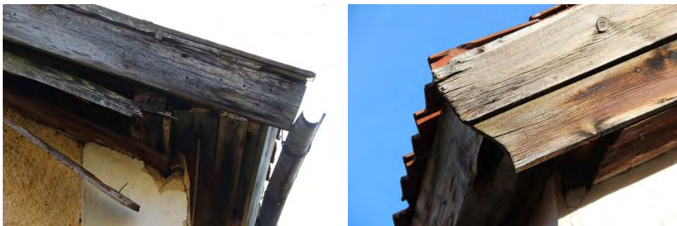
13118_122. Skada i gavelns språng och vindskena på norra gaveln, här syns även en bevarad hängränna. 13118_104. Ornerad vindskena på södra gaveln.
