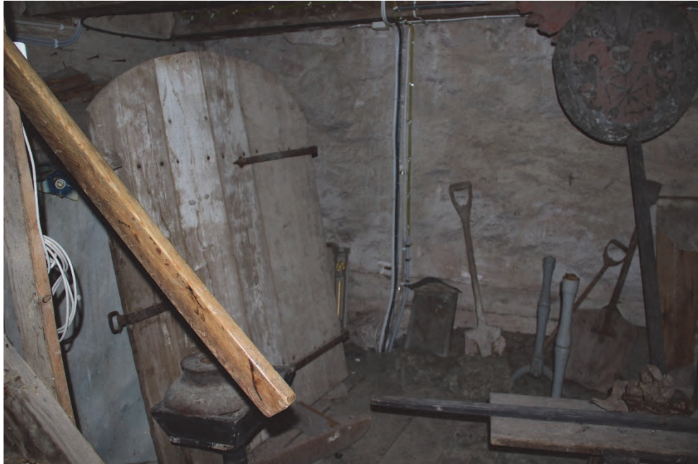
Figur. 26 Delvis nya eldragningar på tornets västvägg. Har utnyttjat en tidigare upptagen håltagning. Tornplan 3. Foto: Helén Sjökvist.
