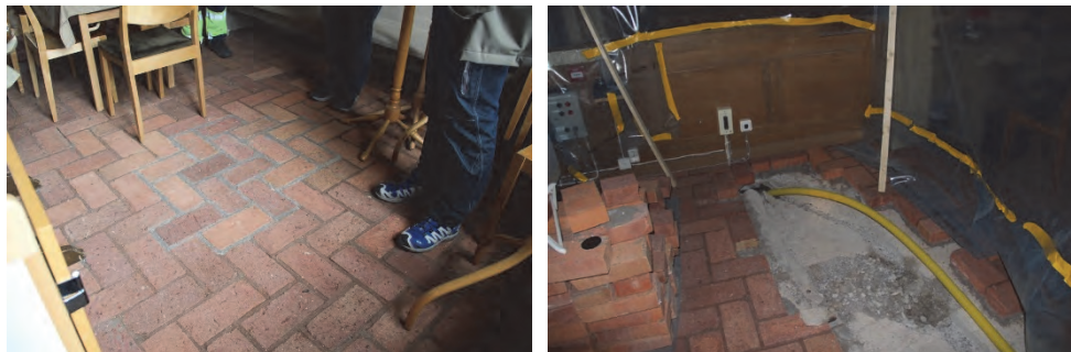
Figur 4. Tegelgolv i långhusets nordvästra del före åtgärder. Golvet var sedan tidigare upptaget för en provgröp i samband med förstudien 2007. Fogarna avvek från äldre fogbruk. Foto: Lisa Skanser.
