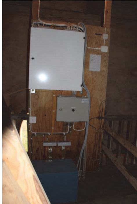
Figur 24. Tornets elcentral efter åtgärder. Foto: Helén Sjökvist.
