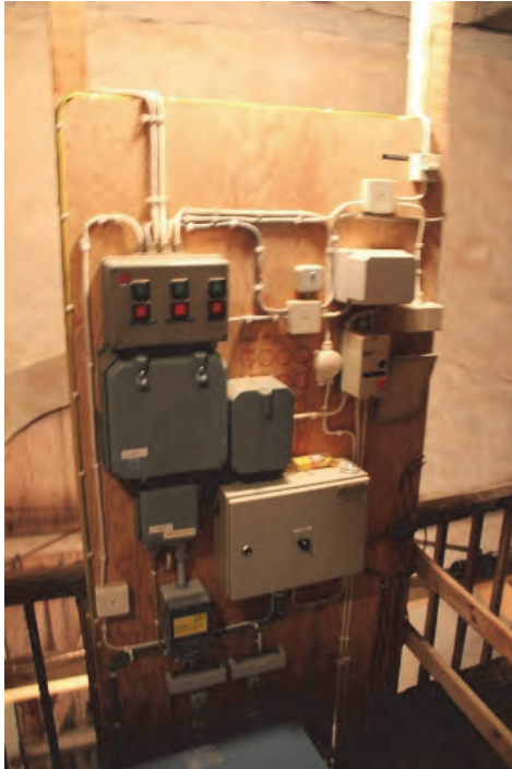
Figur 23. Tornets elcentral före åtgärder. Foto: Lisa Skanser.
