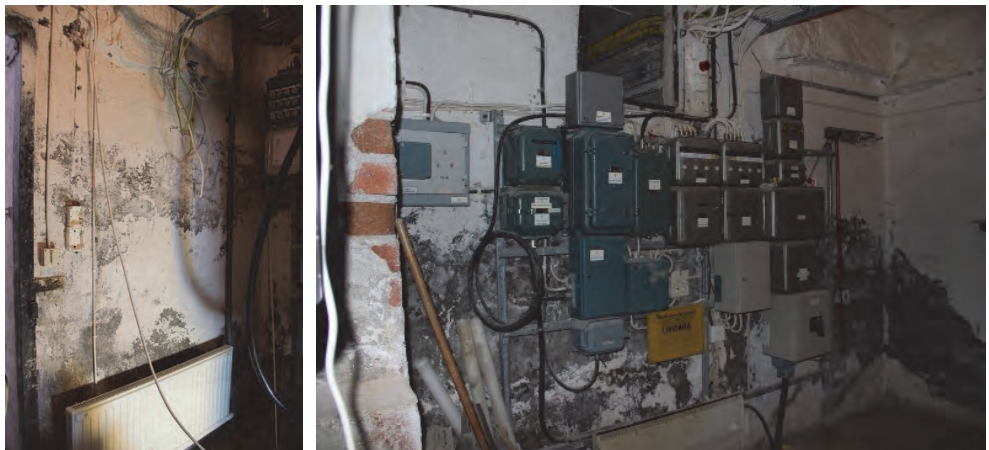
Figur 27. Källaren under sakristian före åtgärder. Foto: Lisa Skanser.
