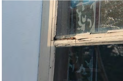
Figur 5. Röttskador på spröjs. Korfönster. Foto: Lisa Skanser.
