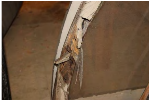
Figur 33. Skador i korffönster. Foto: Lisa Skanser.
