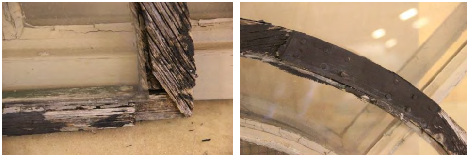
Figur 25. Skador i del av runt tornfönster. Foto: Lisa Skanser. Figur 26. Äldre lagning av runt tornfönster. Foto: Lisa Skanser.
