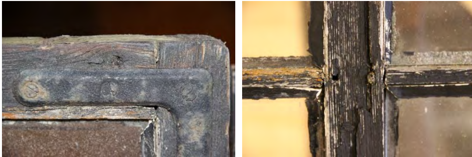
Figur 23. Uttorkat virke på vindsfönster. Foto: Lisa Skanser. Figur 24. Spröjsmöte yttersida tornfönster. Foto: Lisa Skanser.
