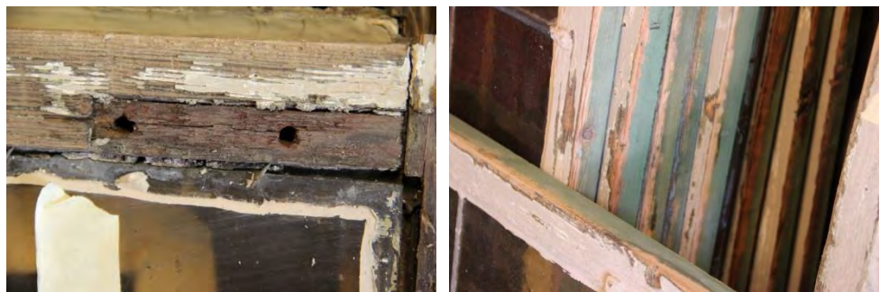
Figur 19. Hålen för hörnjärnen behövde borras upp och pluggas för att få bort skadat trä och rost. Foto: Lisa Skanser.
