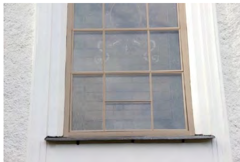
Figur 47. Korvfönster åtgärdat. Foto: Lisa Skanser.
