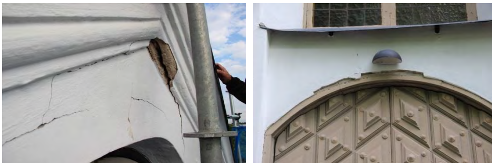
Figur 55. Puts-skador på östra gaveln, över vindsfönster. Foto: Lisa Skanser.
