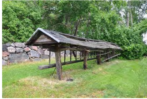
Figur 6. Sett från sydväst, innan åtgärd. Här framgår att stegtaket var skevt och att södra takfallet var i dåligt skick. Foto: Tobias Mårud.
