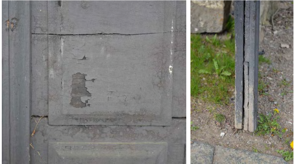
Figur 53. Torr och flagnande färg samt en torrspricka i träet. Dörren i norra stigluckan har inte målats med samma opassande färg som dörren i västra stigluckan. Här är underhåll betydligt enklare och angrepp av röta som synes obefintligt. Foto: Tobias Mårud.
