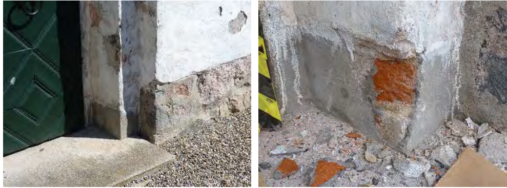
Figur 22 & 23. Vapenhusets portal hade samma problem som västportalen, här östra sidan med en hård cementputs på sockeln vilket ytterligare bidrar till kapillärsugning av fukten. Foto: Tobias Mårud.
