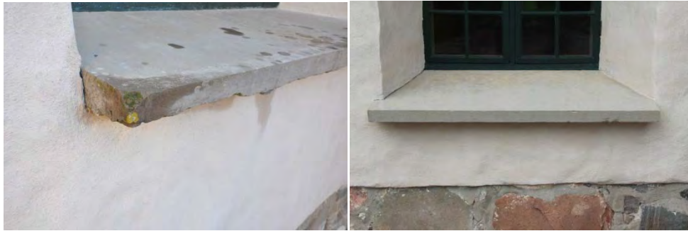
Figur 54 & 55. Samtliga solbänkar rengjordes. Bilderna visar fönstret väster om vaktmästarkontoret i långhusets södra fasad, innan och efter rengöring. Foto: Tobias Mårud.
