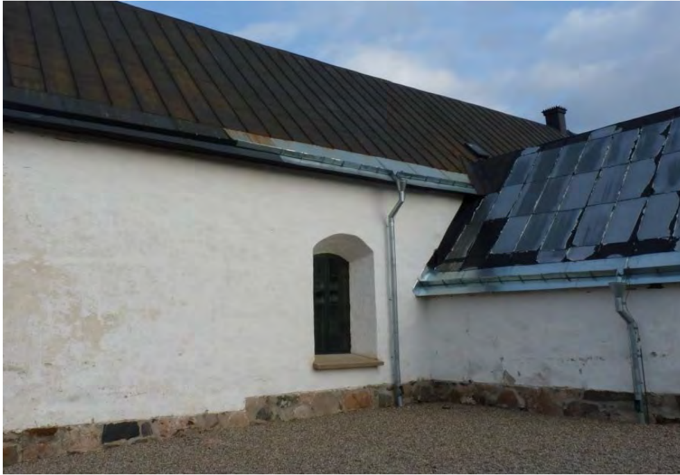
Figur 11. Innan åtgärd var fasaderna avfärgade i en relativt neutral vit ton. Foto: Helén Sjökvist.
