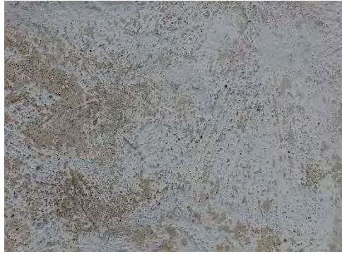
Figur 8. Under fasadens vita anfärgning finns en mer gultonad puts. Foto: Lisa Skanser.
