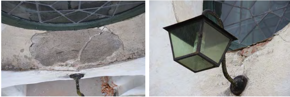
Figur 47 & 48. Nederdelen av fönsteröppningen i västra gaveln är en naturlig ansamlingspunkt för vata med frostsprängning och fuktskada som följd (vänstra bilden). Armaturen nedanför fönstret var i behov av underhåll, bland annat växte lavar på metallen (högra bilden). Foto: Tobias Mårud.
