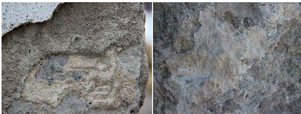
Figur 56 & 57. Vänster bild visar några av de puts- och avfärgningslager som fanns på fasaderna. Den högra bilden visar rester med avfärgning i kulör NCS S 1515-Y40R från västra gaveln. Foto: Tobias Mårud och Lisa Skanser.
