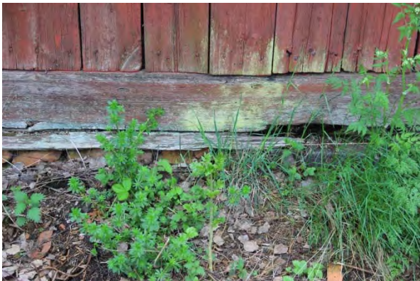
Grundmuren är delvis helt täckt av den höjda marknivån
