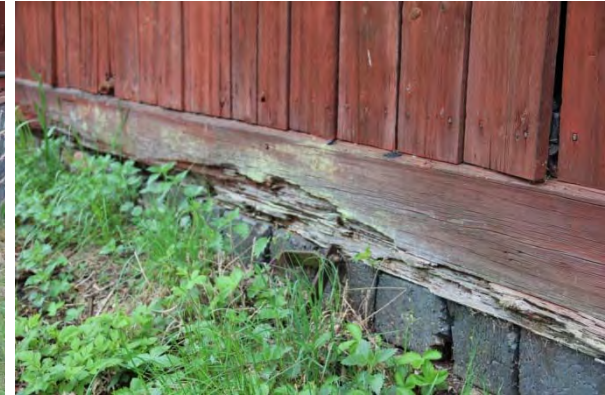
Fuktproblem och förhöjd marknivå vid nordvästra fasaden har lett till rötskador i vatt- och syllbräda
