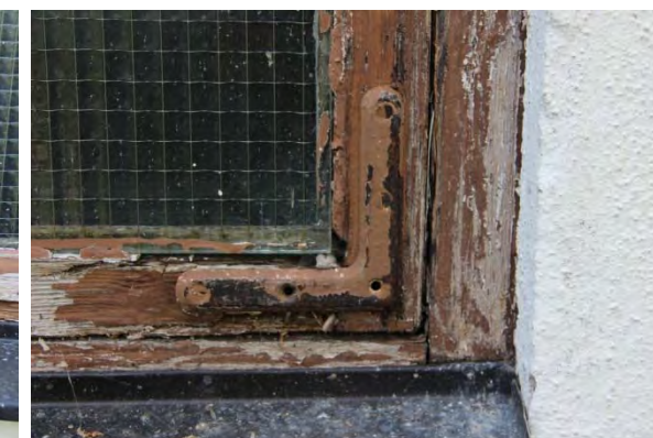
Fönstret har även behov av allmänt underhåll
