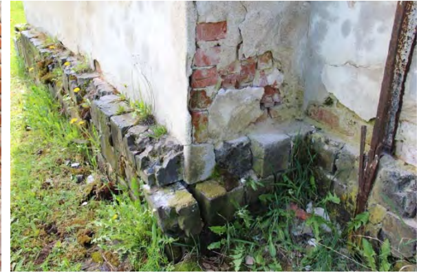
Diverse skador på rökgång och skorstensfundament
