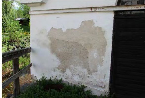
Dåligt fäste av avfärgningen på nordvästra gaveln
