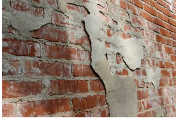
Stora problem med att få putsen att fästa på skorstensfundamentets och rökgångens murverk
