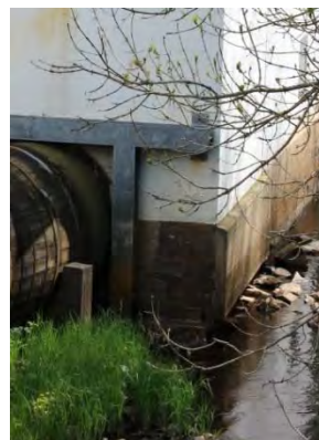
Skada på nordvästra gaveln
