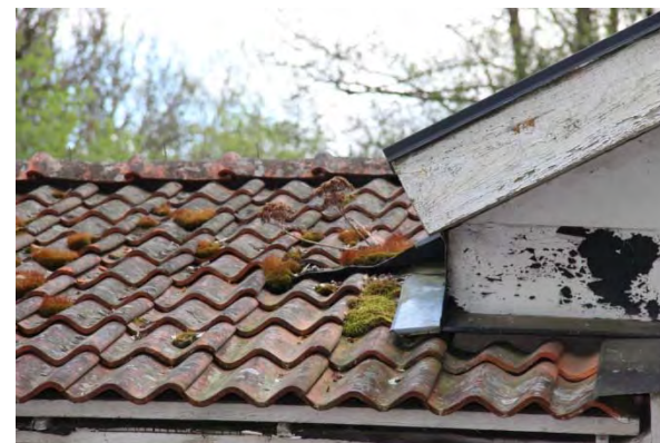
Flagande färg på ståndplåt, nordvästra gaveln
