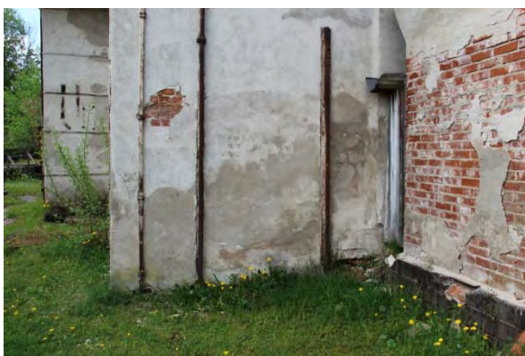
Hörnan vid fundamentet till skorstenen har problem med fukt
