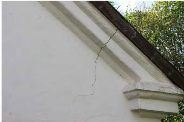
Spricka i nordvästra gaveln
