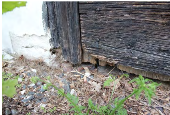
Äldre skada i nederkant av dörr i sydvästra fasaden
