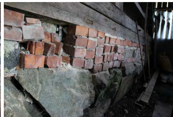
Nordvästra väggen kalvar påtagligt inåt
