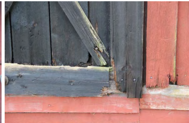
Skador i ändträ, här nordöstra gaveln
