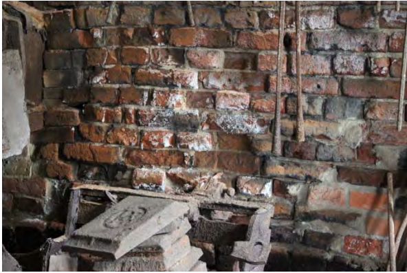
Saltutfällning i skadat murverk, ugnsdelen i nordöst
