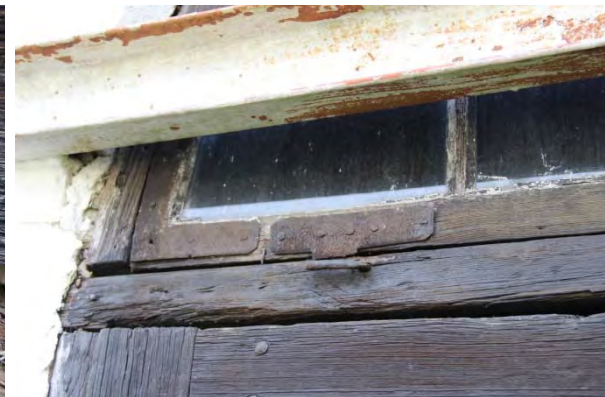
Metallbeslag som delvis förlorat sin funktion, lunettfönster i nordvästra gaveln
