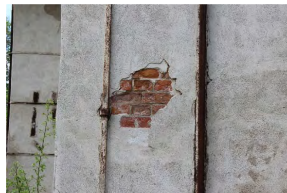
Putsskada på nordöstra fasaden.
