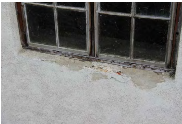
Ett exempel på skadorna i fönsteröppningarnas underdel
