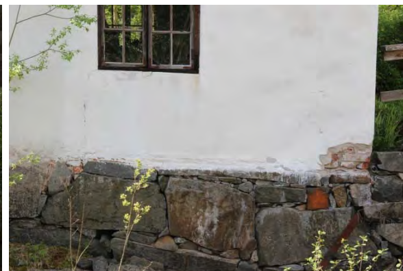
Del av nordöstra fasaden, spricka under fönster och putskada i nedre hörnet
