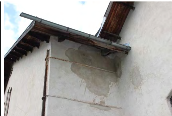
Putslagning med avvikande kulör, sydöstra gavelns nordöstra fasad
