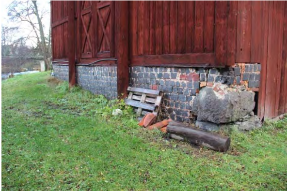
Sydvästra gavelns grundmur, skador vid hörnsten
