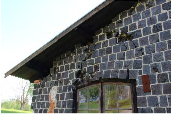
Kraftig spricka i östra inlastningsrummets nordvästra gavel
