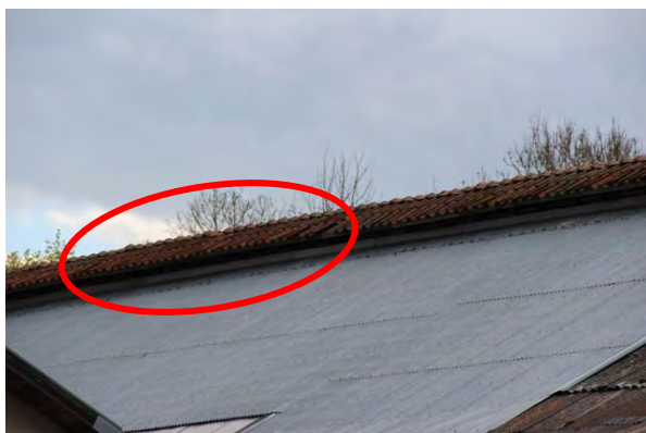
Skadade och lösa takpannor inom markering
