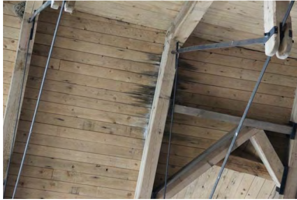
Fuktskada i blåsmaskinshusets tak
