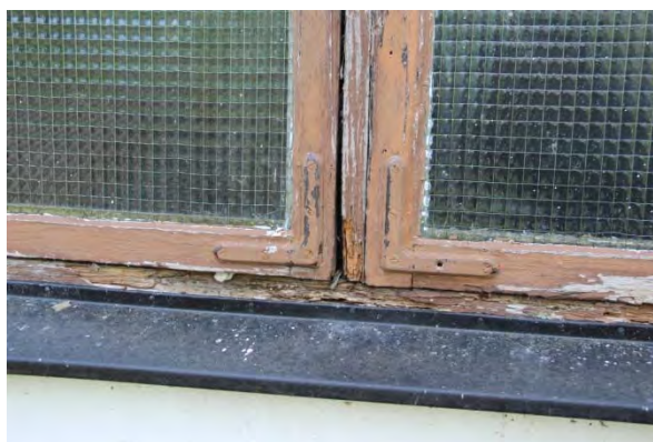
Virkeslagning krävs på fönstret i kontorsdelens nordöstra gavel
