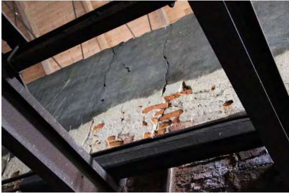
En av flera sprickor i nordöstra ugnsdelens murverk
