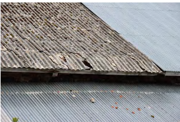
Skador i asbestcementplattorna, sydvästra takfallet
