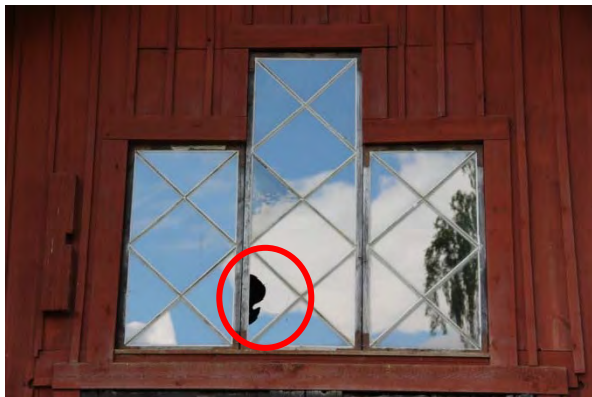
Trekopplade fönster i vardera gavelröste. Trasig ruta på nordöstra gaveln, inom markering
