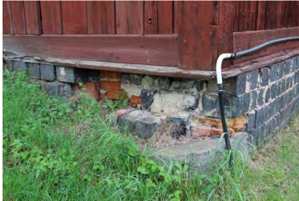
Skador även vid nordvästra fasadens sydvästra hörn
