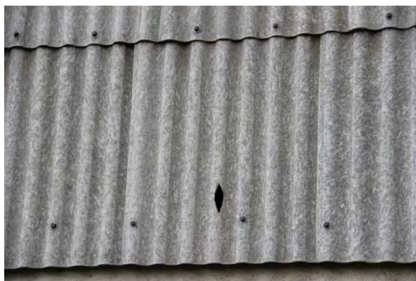
Skada i asbestcementplatta på nordvästra gaveln
