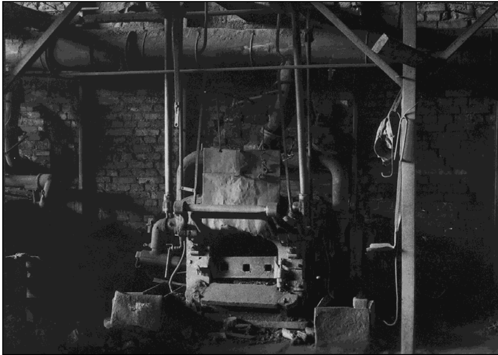
Interiörbild från 1951 som visar en av de fyra äldre lancashirehårdarna, med hjälpbrytare och bakom den en uppdragen skyddsplåt samt vid sidan vasklår för kylning av brytarspetten. Foto: Smeling, VLMS arkiv, beskuret.
