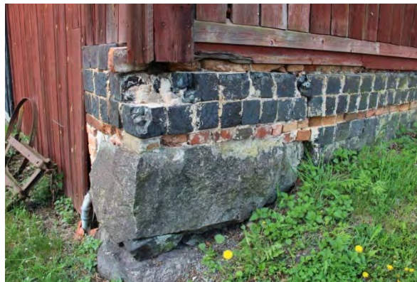
Hörnstenar synliga mot nordöst. Skador i grundmur Spricka i grundmur på nordöstra gaveln och felaktig konstruktion av syllbräda
