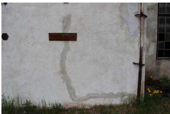
Pågående sprickbildning, sydöstra gaveln
