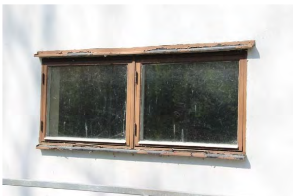
Flagande färg på fönsterbleck, sydöstra gaveln
