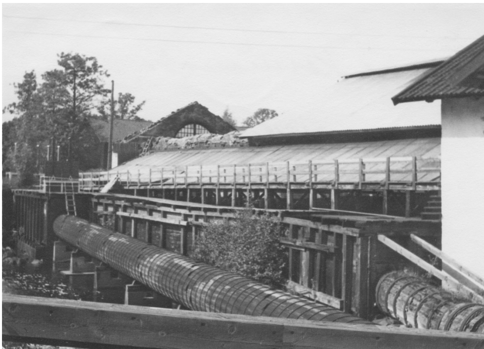
Figur 7. Hammarsmedjan sedd från söder efter takraset 1951. Källa: VLM.
