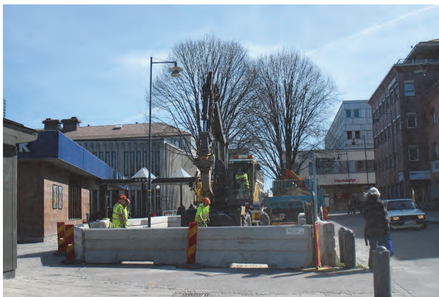
Figur 5. Platsen för schakt 2 där det framkom kulturlager från 1200-talet. Fotografat från norr av Jonas Ros.
