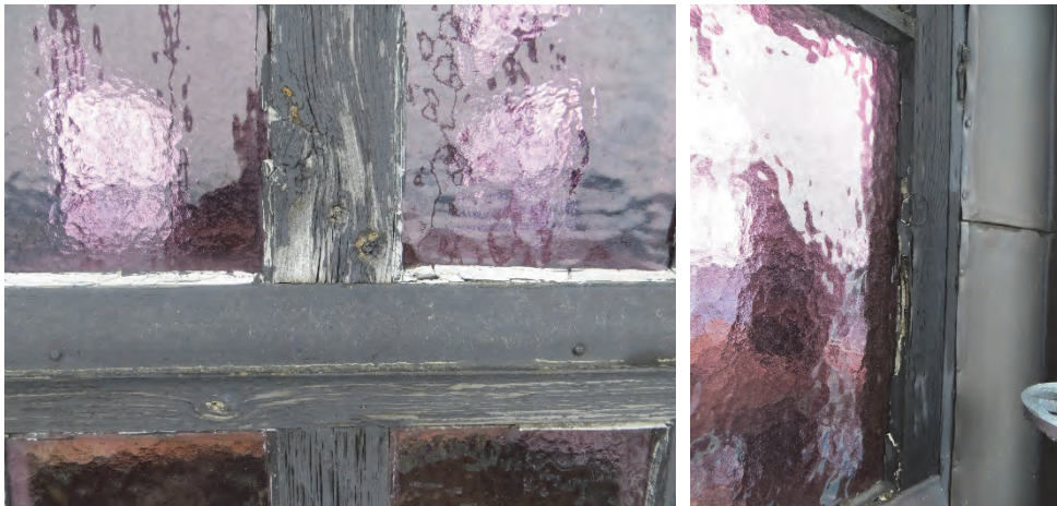
Figur 11. Skadad spröjs. Foto: Helén Sjökvist.
