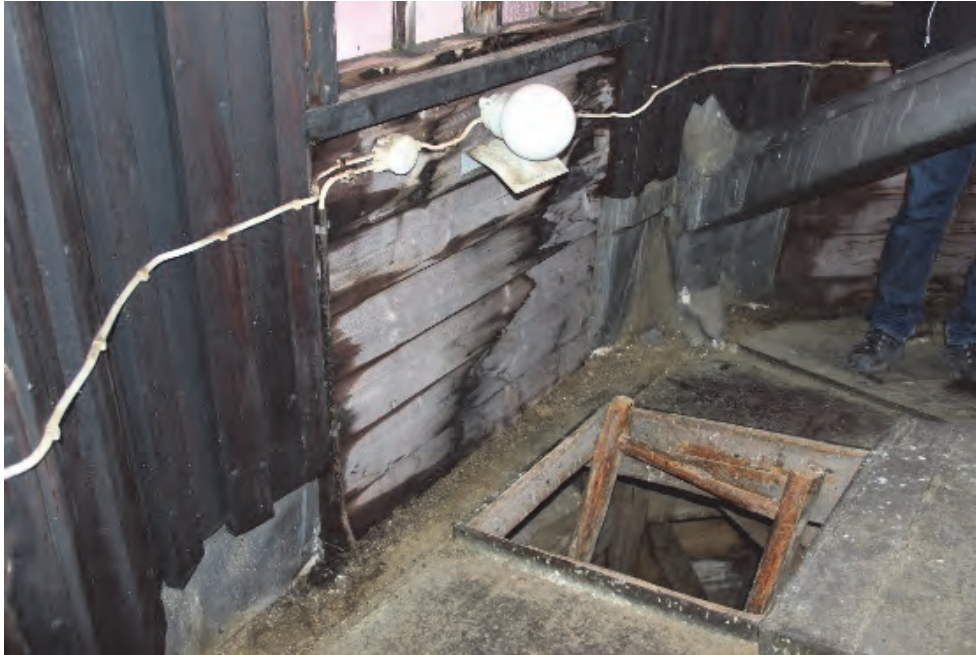
Figur 25. Området under fönstren har varit utsatta för fukt. Foto: Helén Sjökvist.
