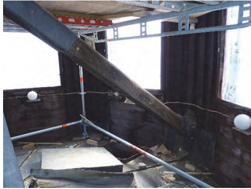
Figur 36. Demonterad plåt från stödben. Foto: Helén Sjökvist.
