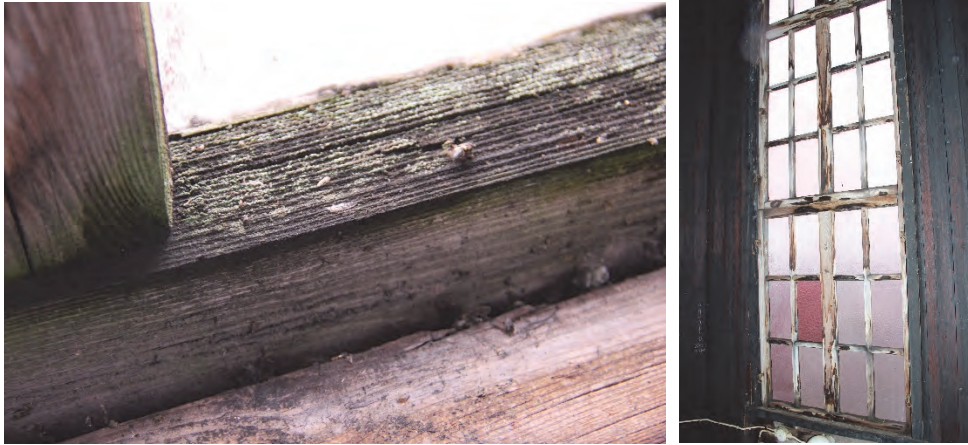
Figur 9. Detaljbild av fönsterbåge före åtgärder. Virket håller hög fukthalt och har lav- och algpåväxt. Foto: Helén Sjökvist.
