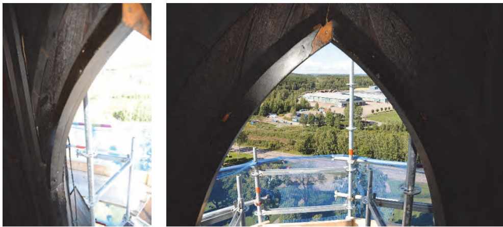
Figur 16 och 17. Trälagningar av spetsbåge i lanterninfönster. Foto: Svensk Klimatstyrning.
