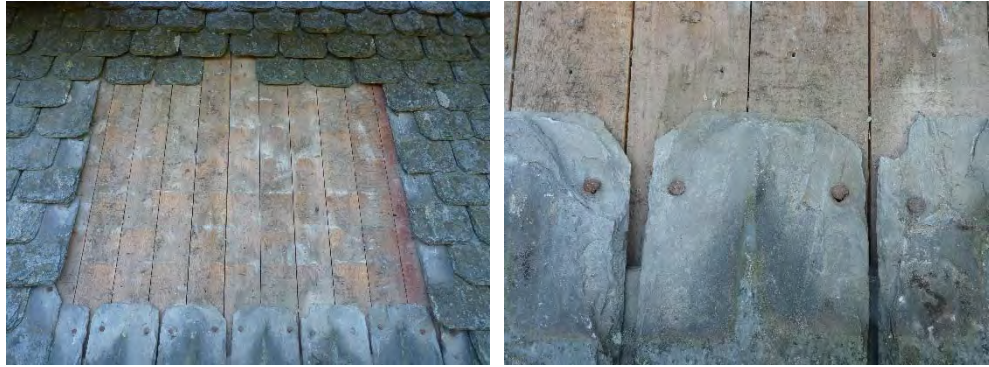
Figur 8 & 9. Provruta på norra takfallet. Skiffern är fästade direkt i räsponenten med spik som angripits hårt av rost. Foto: Tobias Mårud.
