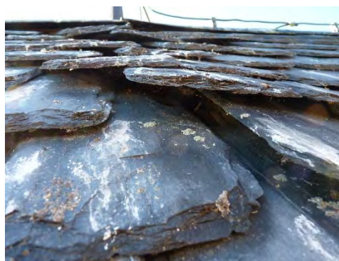
Figur 7. Otät läggning i anslutning till fäste för nockprydning. Foto: Tobias Mårud.
