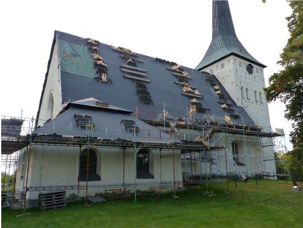
Figur 13. Pappen är lagd. Området över den rötskadade takstolen har lämnats öppet, ingen plywood eller papp har lagts där, och täcks temporärt med en presenning. Foto: Tobias Mårud.
