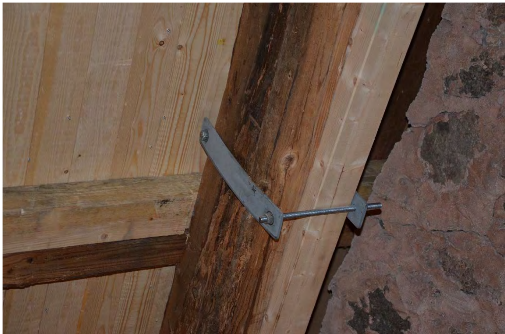
Figur 32. Det skadade högbenet stagades genom en regel fäst längs östra sidan med hjälp av sex stycken skruvförband. Foto: Tobias Mårud.
