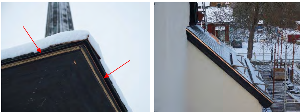
Figur 23 och 24. Sakristians nya fotplåt kan skönjas på bilden till vänster (markeras med pilar). Höger bild visar exempel på plåten som tillkom på vindskivornas övre kant, här på sakristians södra gavel. Foto: Tobias Mård.
