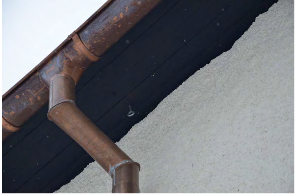
Figur 26. Avvattning i koppar, stuprör med skarpa böjar. Foto: Tobias Mårud.
