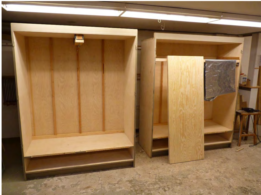
Figur 10. De äldre skåpen forslade till verkstad för ombyggnation Foto: Tobias Mårud.
