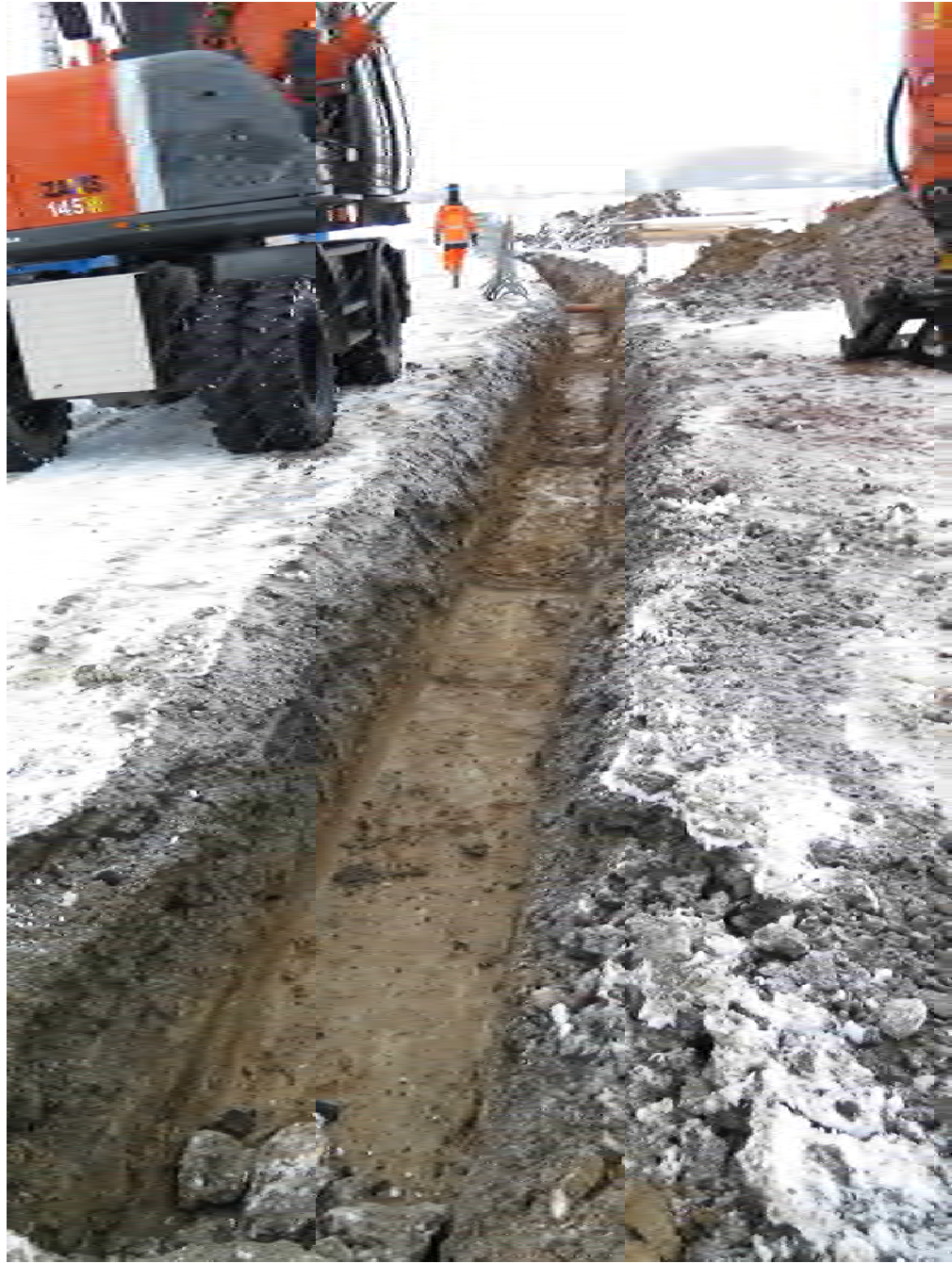
Figur 5. Östra halvan av den öst-västligt orienterade delen av fjärrvärmeschaktet från väster. Strax hitom markröret börjar det påförda lagret med dräningsgrus på markduk. Foto: Mattias Johansson.
