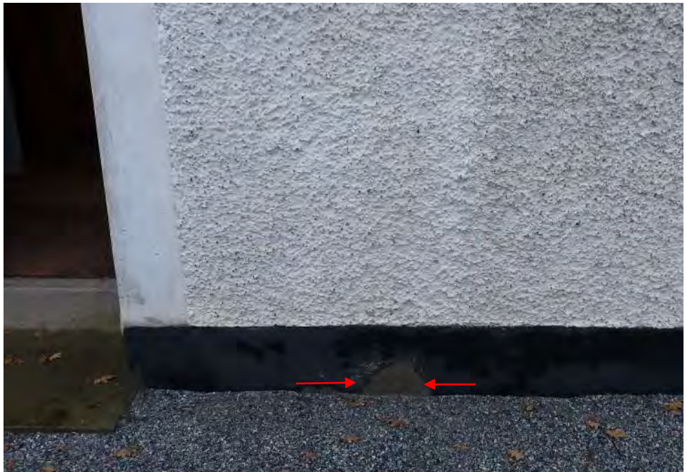
Figur 35. Lagning efter äldre håltagning ovan mark, ej inmålat. Foto: Helén Sjökvist.
