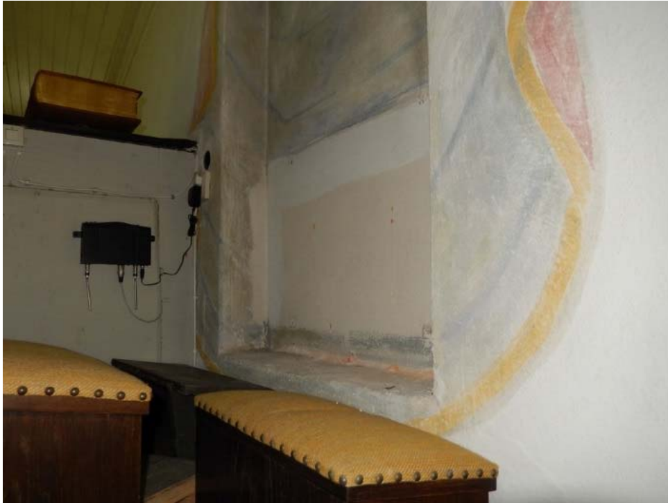
Figur 17. Radiatorn är demonterad men de gamla skruvhålen finns kvar i väggen. Foto: Svensk Klimatstyrning.
