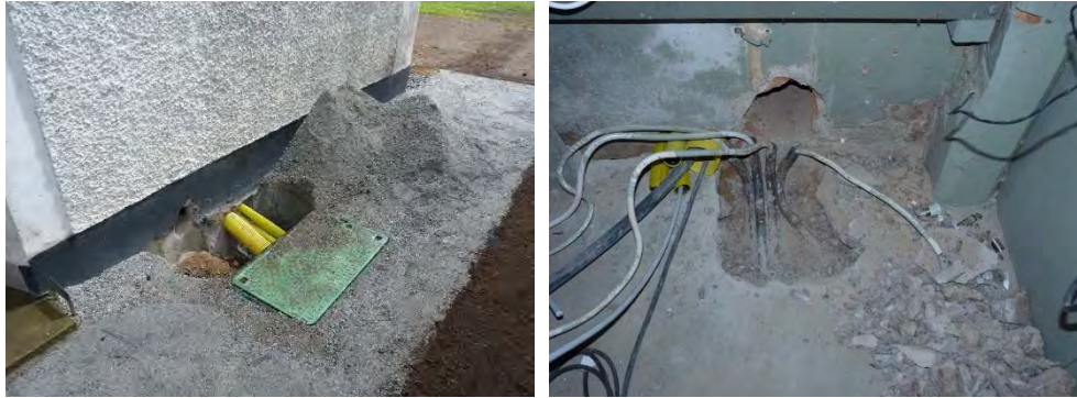
Figur 33. Nya hål borrade genom grundmuren, snett under den äldre håltagningen. Foto: Helén Sjökvist.
