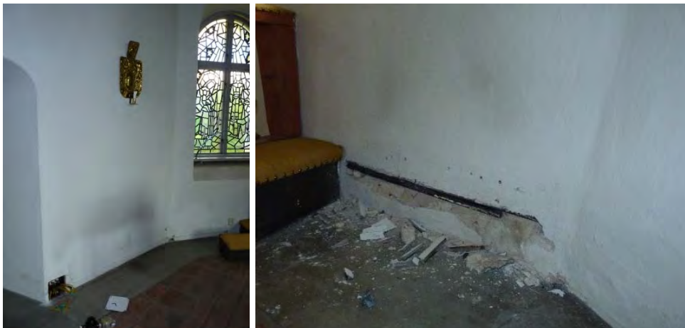
Figur 20. Radiator på korets norra sida demonterad. Sotiga ytor. Foto: Helén Sjökvist.
