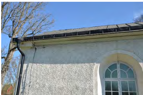
Figur 12. Befintlig åskeledarlina på södra fasaden. Foto: Tobias Mårud.
