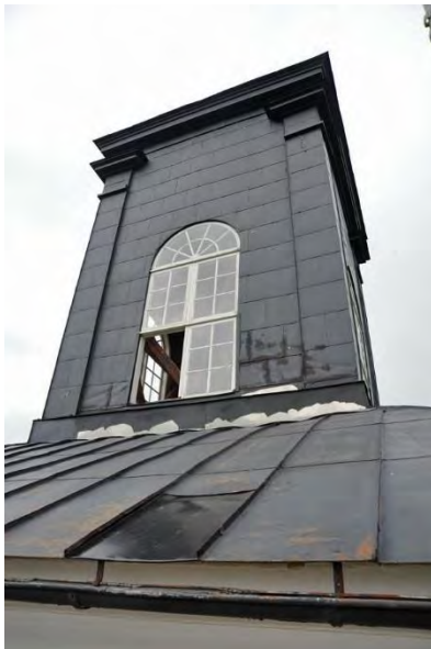
Figur 56. En plåt i framkanten är utbytt 2014. Foto: Svensk Klimatstyrning.
