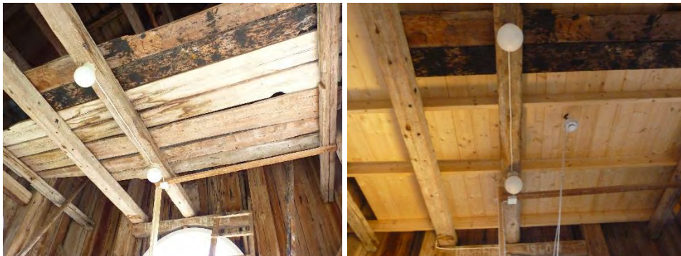
Figur 47. Äldre bjälklag i tornlanterninen med löst utlagda plankor. Foto: Helén Sjökvist.
