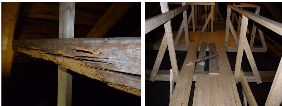
Figur 51. Rötskada i bjälke har ej åtgärdats. Foto: Helén Sjökvist.
