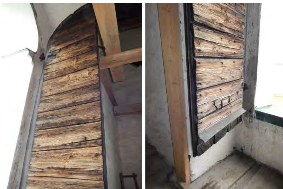
Figur 37 och 38. Ljudluckor före tjärning. Foto: Svensk Klimatstyrning.
