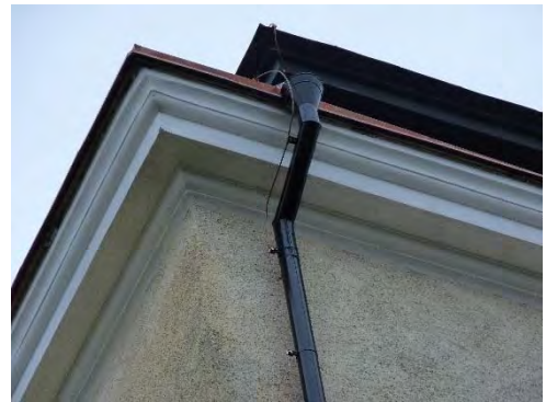
Figur 36. Nyttillkomna stuprör med skarpa vinklar. Foto: Helén Sjökvist.
