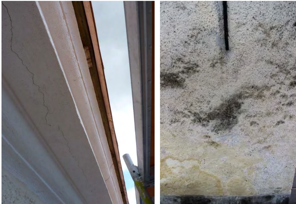
Figur 29. Spricka i gesims på tornets södra sida. Figur 30. Puttskador och missfärgningar på tornets norra sida. Foto: Tobias Mårud.
