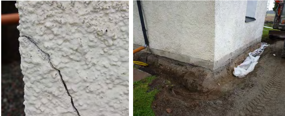
Figur 39. Sättningspricka i sakristians nordöstra hörn. Foto: Tobias Mårud.
