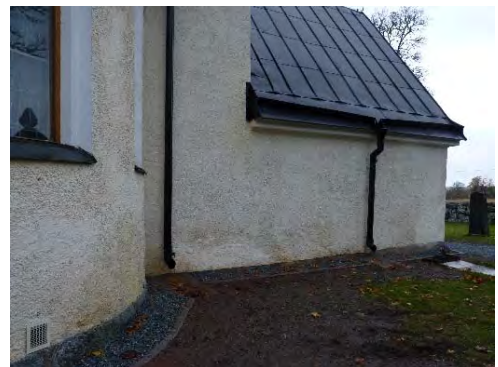
Figur 38. Omputsad yta vid tidigare bortfall. Foto: Helén Sjökvist.
