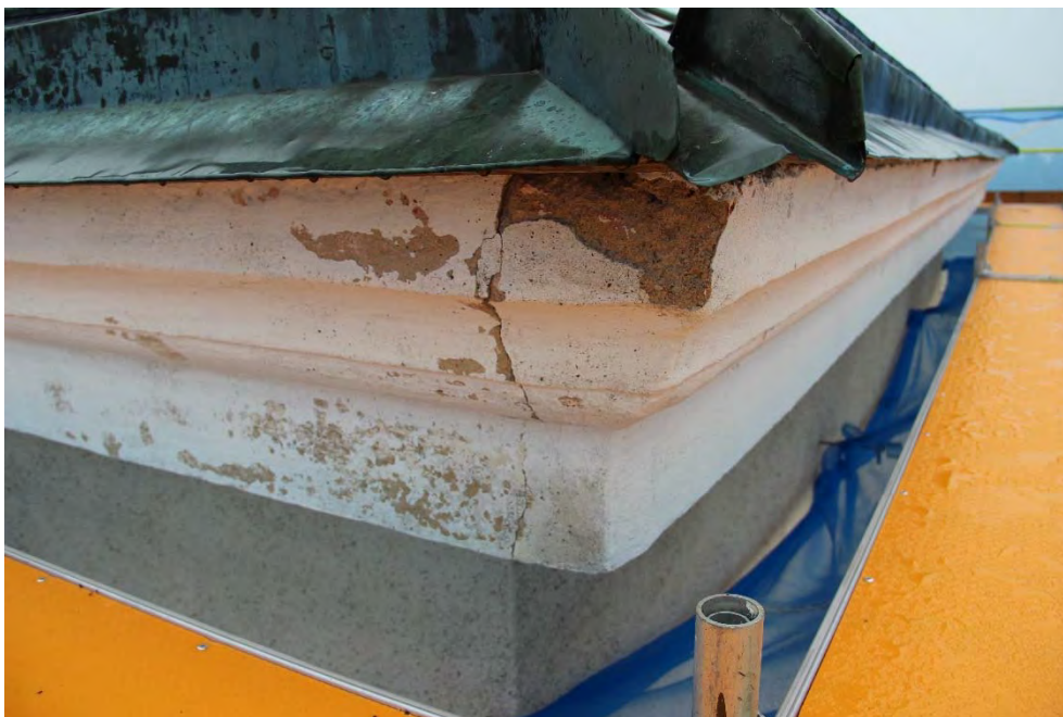
Figur 32. Befintlig utkastare från tornetaket. Den bristfälliga vattenavledningen har lett till skador i gesimsen. Foto: Tobias Mårud.
