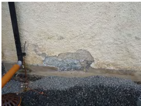
Figur 37. Putsbortfall på sakristians östra sida.
