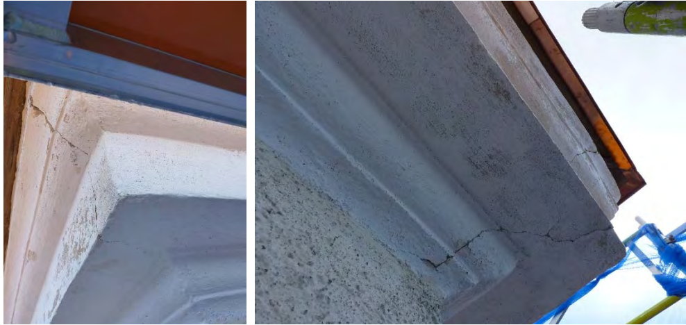
Figur 27. Spricka nordvästra hörnet på torngesimsen. Foto: Helén Sjökvist. Figur 28. Spricka i sydöstra hörnet av torngesimsen. Foto: Helén Sjökvist.
