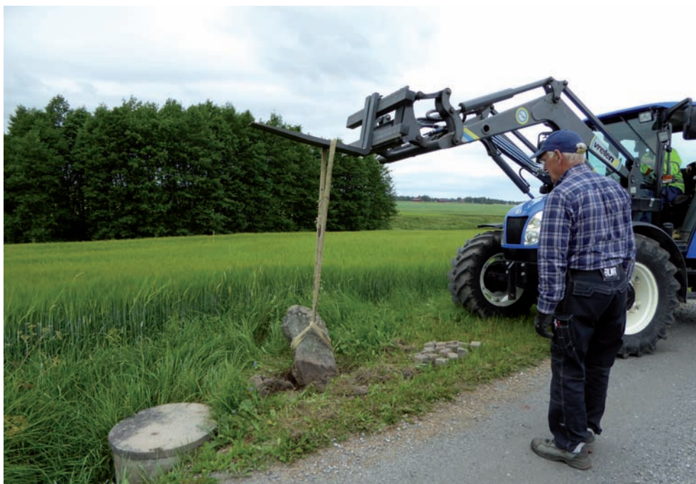
Figur 12. Ringarstenen Björksta 425:1 på väg tillbaka till sin ursprungliga placering. Här har den just lyfts upp från den tillfälliga placeringen vid vägen upp mot Grän. Vid spakarna på traktorgrävaren Bengt Lundmark. Foto från sydost av Anna-Lena Hallgren.
