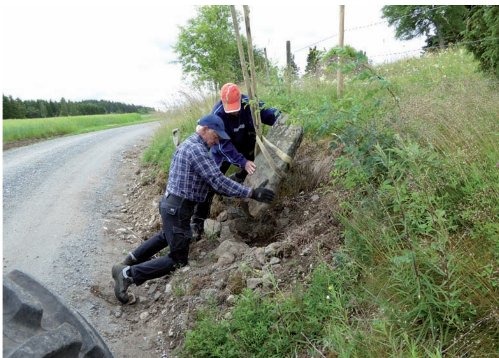
Figur 13. Yngve Ersson och Göte Harrström jobbar med att få stenen på plats. Foto från nordväst av Anna-Lena Hallgren.
