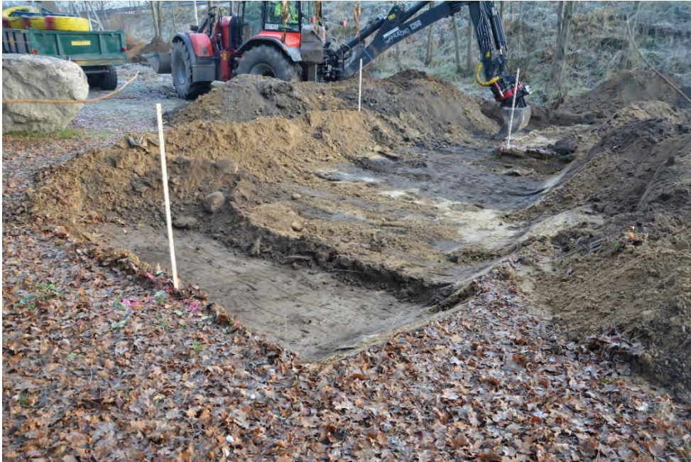
Figur 3. Den del av schakt O100 som utgör grunden för teknikboden, under pågående grävningsarbete. Fotograferad från nordväst. Foto: Mattias Jobansson.
