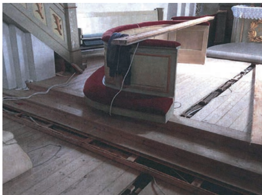
Figur 6 (Övre bilden). Kabelkanalen synlig i mittgång, kor och tvärgående i steg till koret. Foto: Eskilssons El AB.
