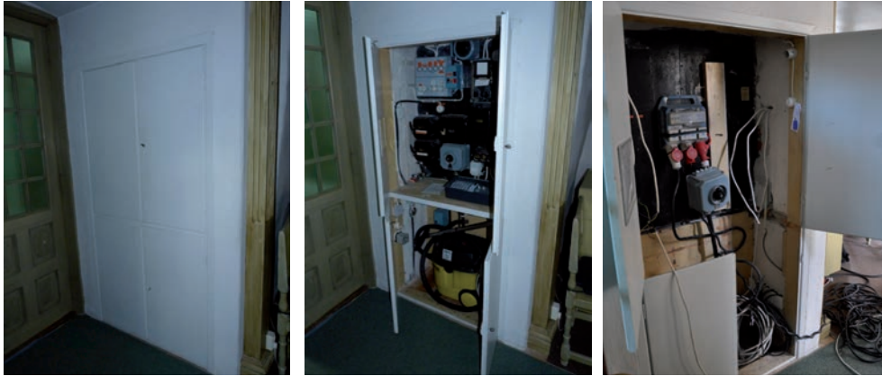
Figur 23 (Vänster). Skåpet för elcentralen innan åtgärd. Foto: Helén Sjökvist.
