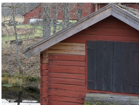
Figur 29. På bilden syns omålat timmer i fasad samt en kort övre utanpåliggande del på vindskivan. Foto: Tobias Mårud.
