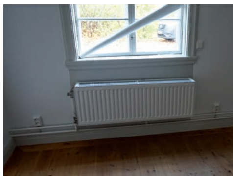
Bild 22. Radiator på plats, observera att eluttagen flyttats för att rördragningen inte ska löpa över sockeln. Foto: Tobias Mårud.
