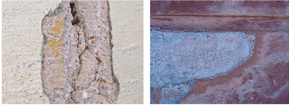
Figur 18. Norra fasaden våning tre. Uppbuggen äldre spricka med spår av underliggande puts med spår av en ockragul kulör. Foto: Helén Sjökvist.
