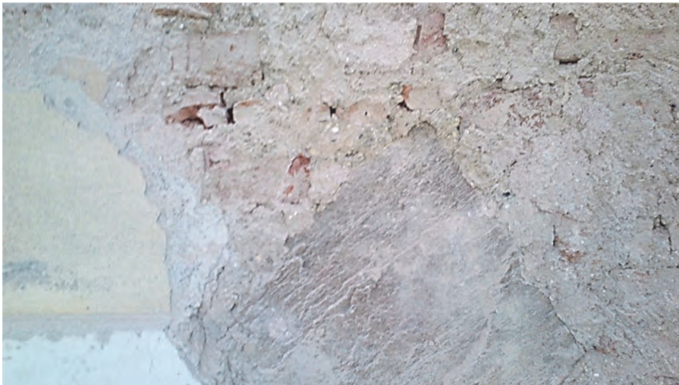
Figur 55. Naturstensinslag syns åtminstone upp till nedre delen av andra våningens fönster. Foto från partiet över sockelvåningen, snett t.v. under tredje fönstret från norr. Naturstensromb i murverket. Foto: Helén Sjökvist.
