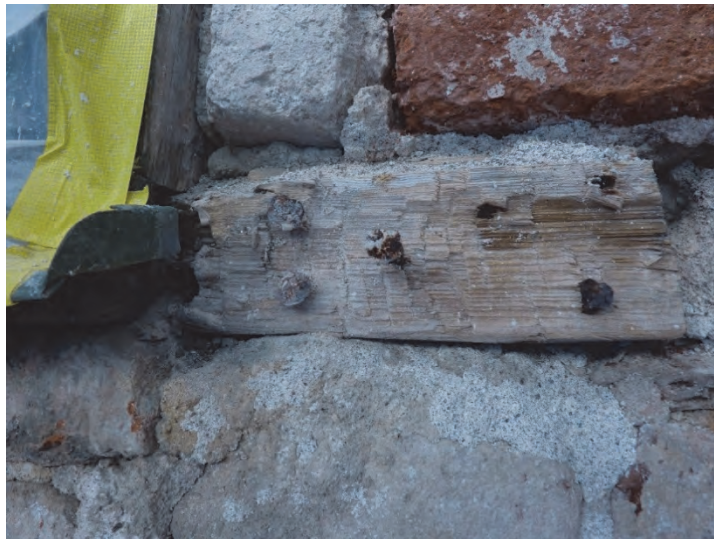
Figur 33. Avsågad fönsterkarm på andra våningen. Spikarna är sannolikt satta i karmen för att ge fäste åt putsen på omfattningen. Foto: Helén Sjökvist.
