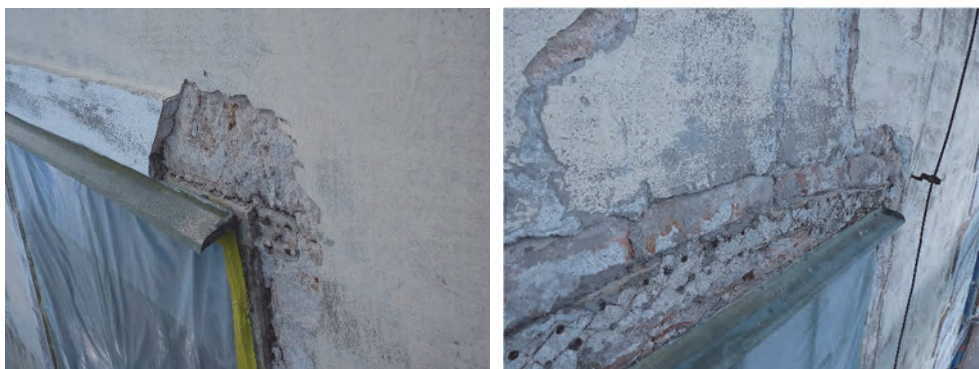
Figur 28. Östra fasaden, 4:e våningen, södra fönstret. Omfattningen har delvis fått knackas ned. Den inputsade karmen har sedan tidigare anpassats och har försetts med spik med stora skallar som putsbärare. Foto: Helén Sjökvist.
