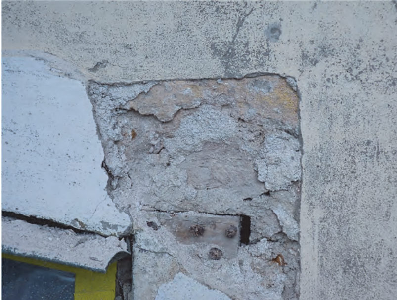
Figur 35. Den putsade omfattningen över det aktuella fönstret är mycket tunnare än kring övriga fönster. En äldre fasadputs som avfärgats med en mörkgul kulör går in under nuvarande vita fönsteromfattning. Foto: Helén Sjökvist.
