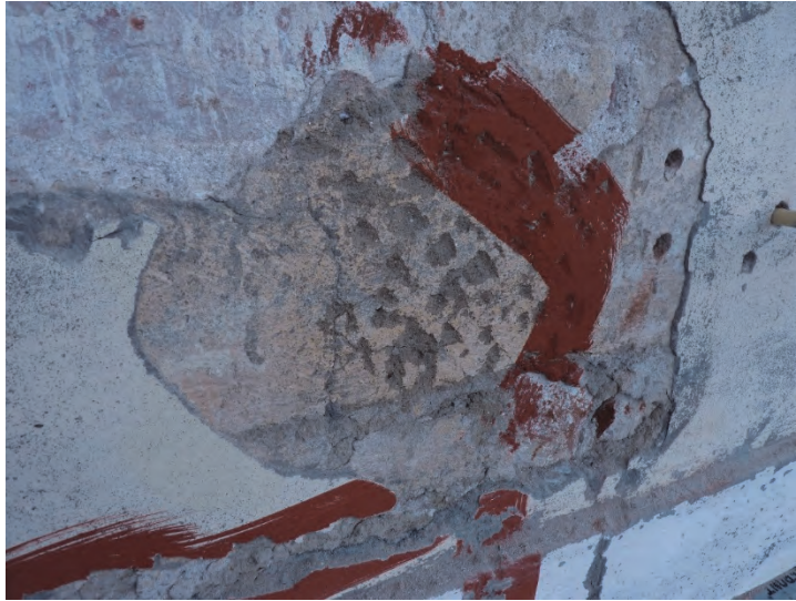
Figur 36. Fjärde våningen, över fjärde fönstret från väster. Befintlig, mycket grå lagning med gul kulör. Foto: Helén Sjökvist.
