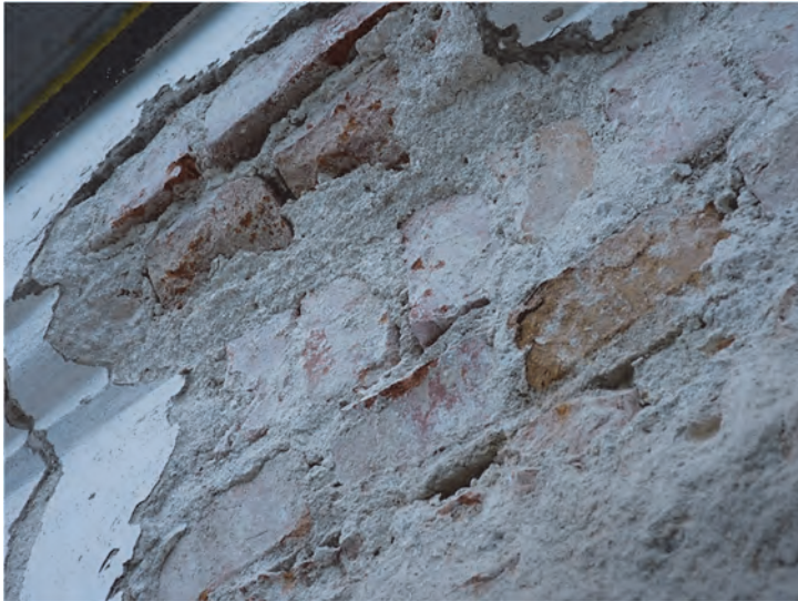
Figur 21. Norra fasaden. Exempel på ojämnt murad tegelmur strax under takefet. Foto: Helén Sjökvist.
