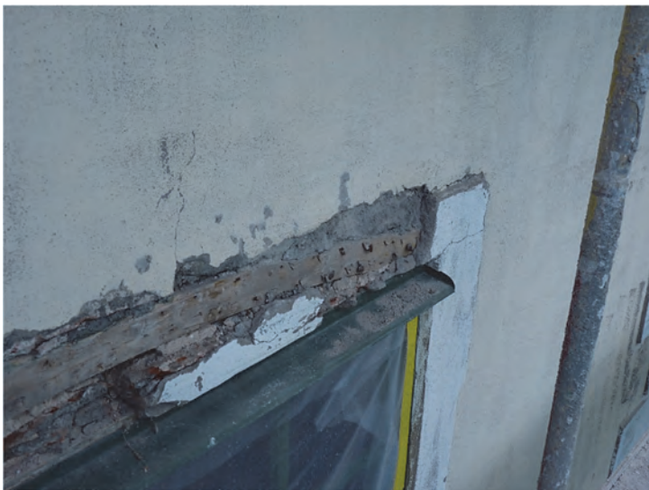
Figur 22. Norra sidan, tredje våningen, fönster längst mot väster. Stickbågigt trästycke över nuvarande fönsteromfattning. Foto: Helén Sjökvist.
