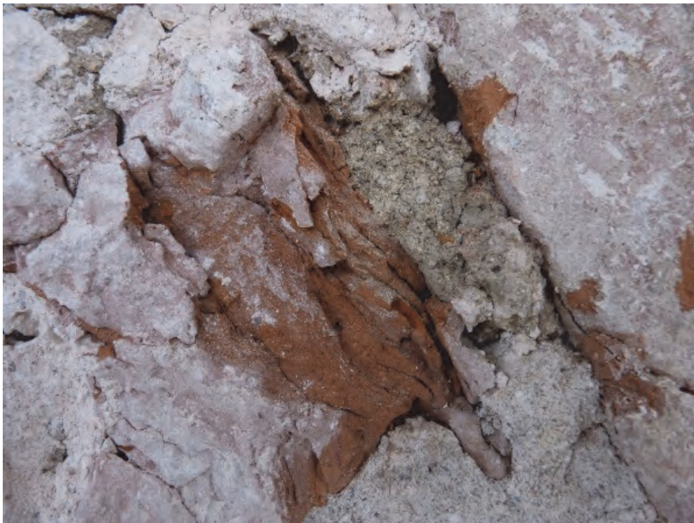
Figur 41. Över fönster fyra från vänster, 3:e våningen. Poröst tegel. Äldre fog av poröst, grått bruk. Foto: Helén Sjökvist.
