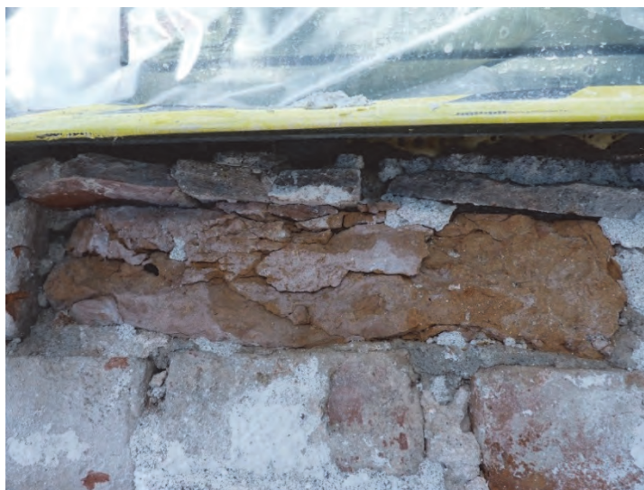
Figur 34. Östra fasaden, första våningen, Fönster näst längst mot norr. Flacka tegelpannor eller plattor har lagts in som utfyllnad upp till karmen. Foto: Helén Sjökvist.
