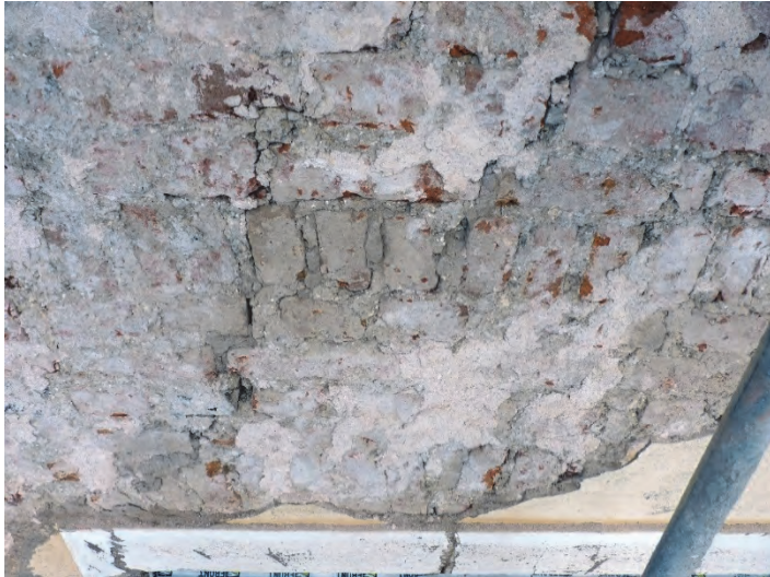
Figur 44. Andra våningen, andra fönstret från väster. Rullförband eller mycket flackt valv. Undre del av tegelstenarna i det förbandet ligger cirka 80 cm över befintligt karmöverstycke. Förbandet löper nästan hela vägen mellan ankarjärnen på ömse sidor fönstret. Foto: Helén Sjökvist.
