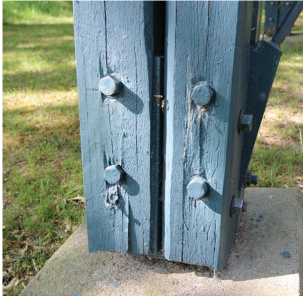
Rötskador i nedre delen av klockstapelns ben. De runda brickorna har trängt in i virket. Foto Lisa Skanser.
