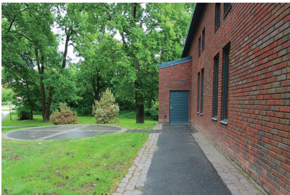
Bilder på utförda markarbeten framför huvudentré och utanför kyrksalens utrymningsdörr. Foto Lisa Skanser.
