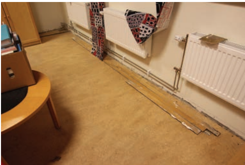
Linoleumgolv i rum 003 innan åtgärd. Foto Lisa Skanser.
