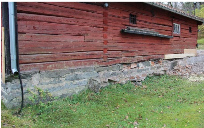
Figur 7. Rötskadad sylv i norra fasaden.
