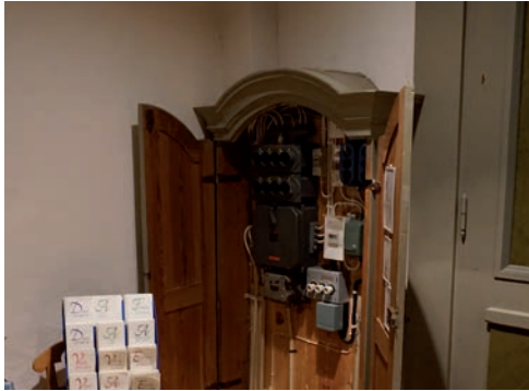
Figur 13. Elcentral i vapenhuset innan åtgärd. Foto: Tobias Mårud.
