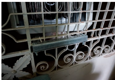
Figur 25. En mindre prydlig montering av värmeflärkten är i stort det ända negativa påpekanget i ärendet. Foto: Tobias Mårud.
