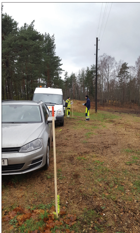
Figur 5. Ledningsutsättningar och diskussioner vid den långsmala objektsytan KM2, belägen under och till höger om de parkerade bilarna. Foto från nordost av Mattias Johansson.
