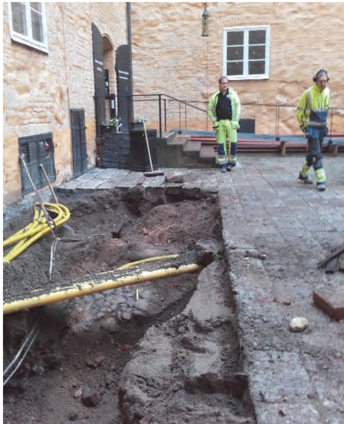
Figur 23. I schakt 6 framkom delar av den äldre stenlagda borggården. Foto från öster av Jonas Ros.
