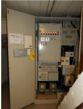
Figur 8. Huvudcentral efter åtgärder.
