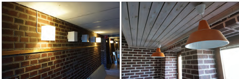
Figur 22. Armaturer i korridor vilka tyvärr avlägsnades.
