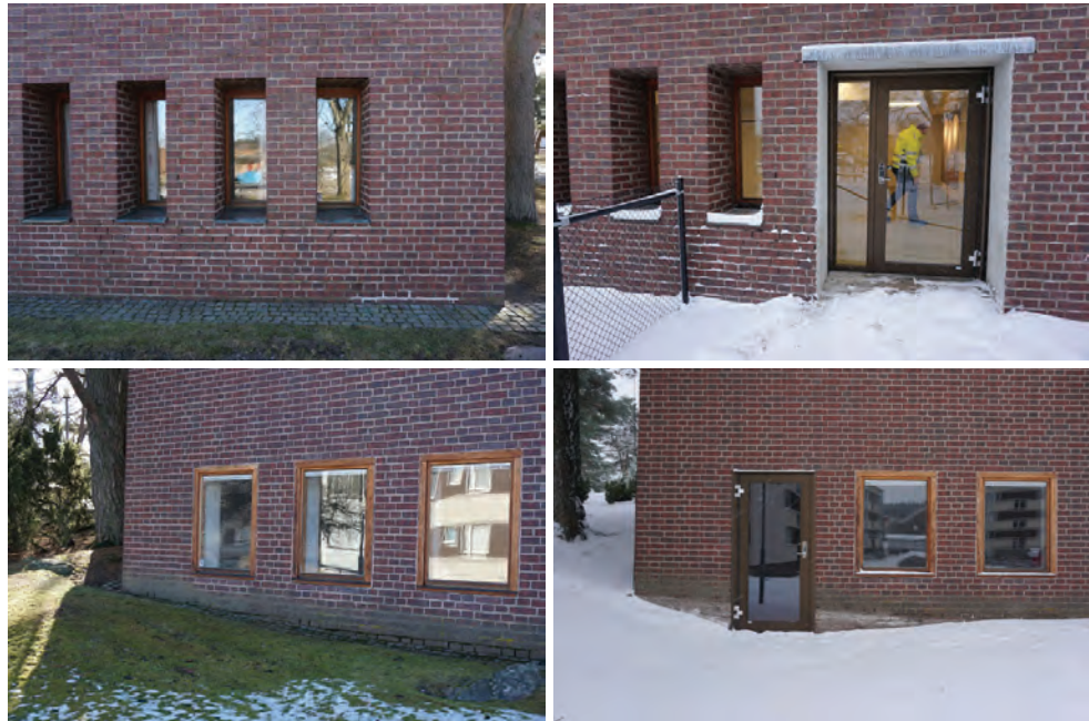
Figur 43. Södra hörnet på nordvästra fasaden innan åtgärd.
