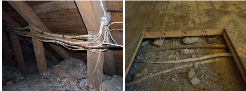
Figur 54. Gamla eldragningar på vinden, norra korsarmen, västra takfallet.
