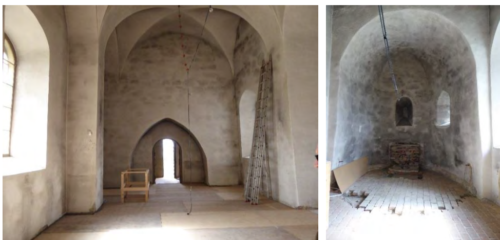
Figur 78. Långhuset sett mot väster. En rörelsedetektor är redan placerad på den pelare på södra väggen dit man omplacerat en ny rörelsedetektor. Ny detektor kommer emellertid att placeras inne i hörnet för att underlätta kabeldragningen.
