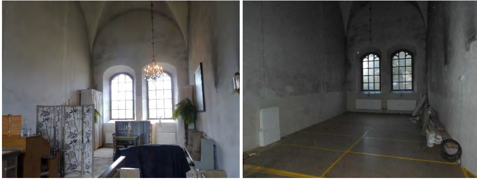
Figur 68. Tidigare elradiatorer under fönster i norra korsarmen.
