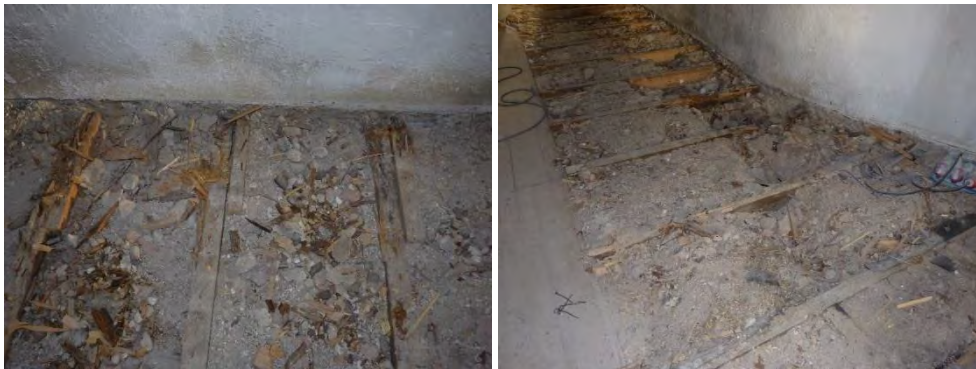
Figur 110. Norra korsarmens östra parti med omfattande rötskador i äldre bjälkar.
