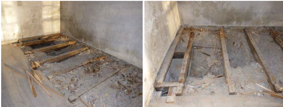
Figur 108. Norra korsarmen, nordöstra partiet, kollapsad blindbotten. Sett mot nordöst.
