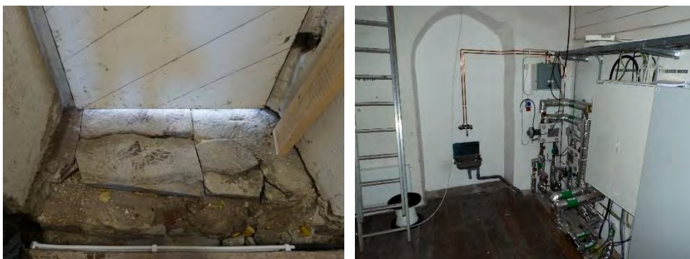
Figur 35. Befintlig tröskel till södra vapenhuset lutade inåt.
