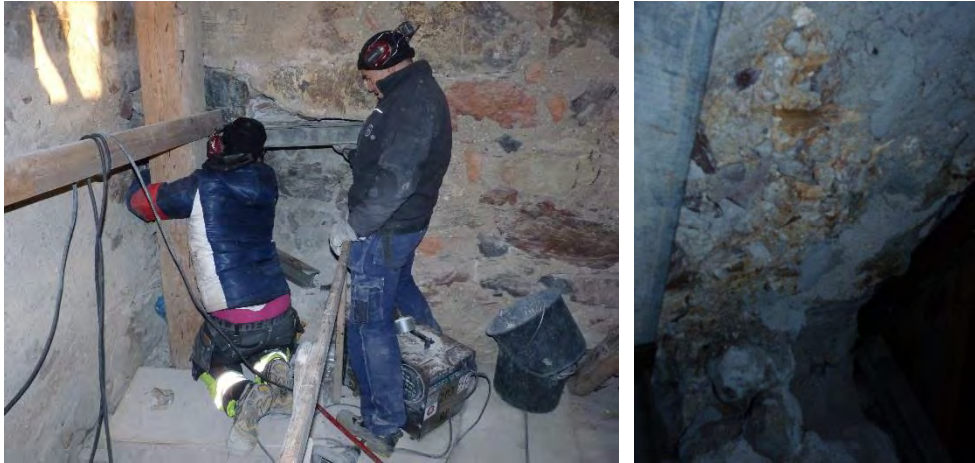
Figur 48. Pågående arbete med upptagning av större öppning i murverket mellan torn och långhusvind, sett från tornet. En I-balk är på väg att sättas in i öppningens övre del.
