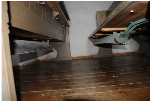
Figur 66. Gamla bänkvärmare. Foto Svensk Klimatstyrning.
