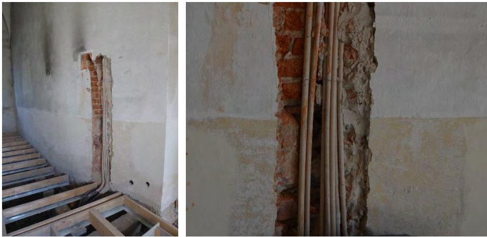
Figur 70. Befintliga eldragningar var sedan tidigare inbilade i väggen mellan norra korsarmen och den tidigare predikstolstrappan. Några av ledningarna flyttades för att få plats med värmerören.
