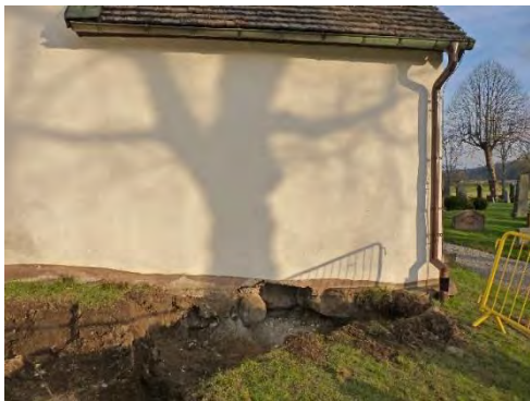
Figur 25. Urfallen sten ur södra vapenbusets västra grundmur.
