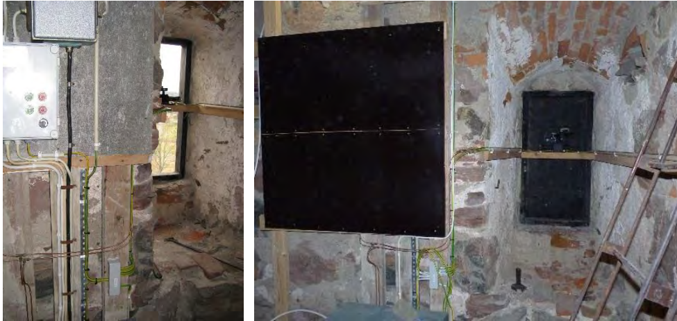
Figur 58. Befintliga elkompnenter i tornet monterade på en eternitskiva. Borttagen. Figur 59. Ny plyfaskiva för montage av elinstallationer.
