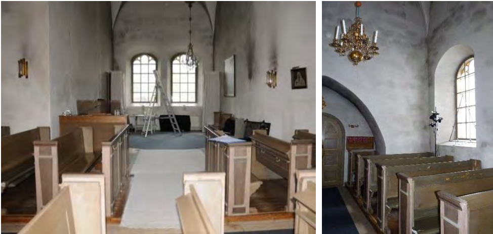
Figur 174. Omfattande torkskador på bänkarnas bemålning.
