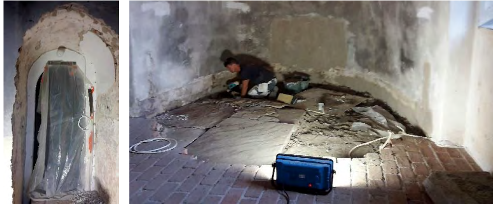
Figur 82. Nedknackade yngre putslager i passage mellan södra vapenhuset och långhuset. Foto Göran Berglund.
