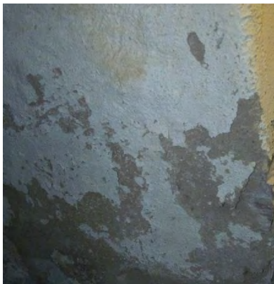
Figur 161. Spår av färg och grå, underliggande puts på södra väggen i kryptan.
