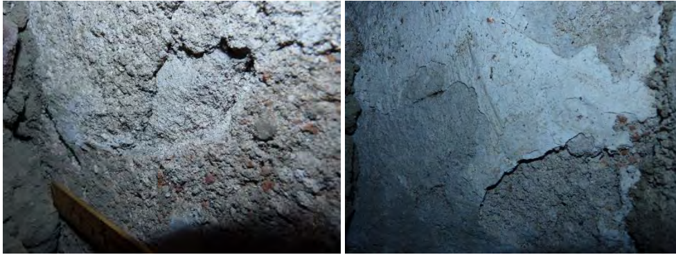
Figur 138. Under den tegelkrossrika putsen ligger ytterligare ett putslager, centralt i bild, med ett ljust kallebruk.
