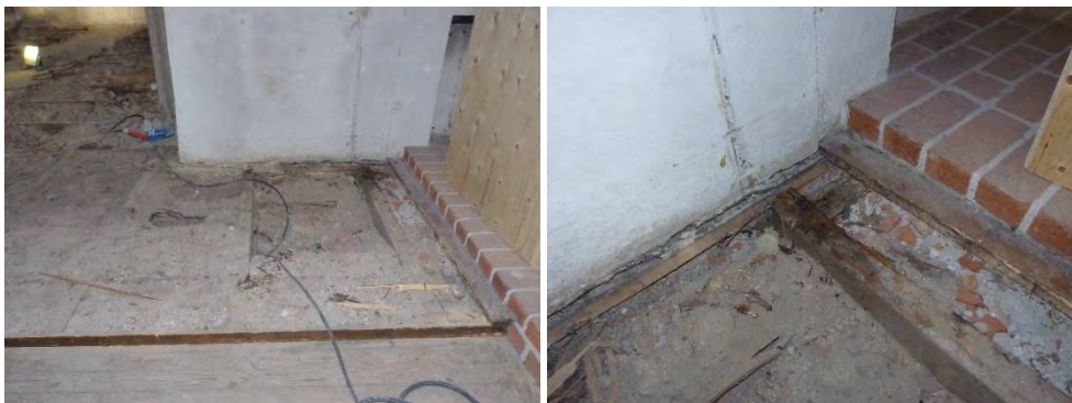
Figur 112. Norra bänkkvarterets östra parti, anslutning till kor. Rötskador i bjälkar samt kollapsad blindbotten.
