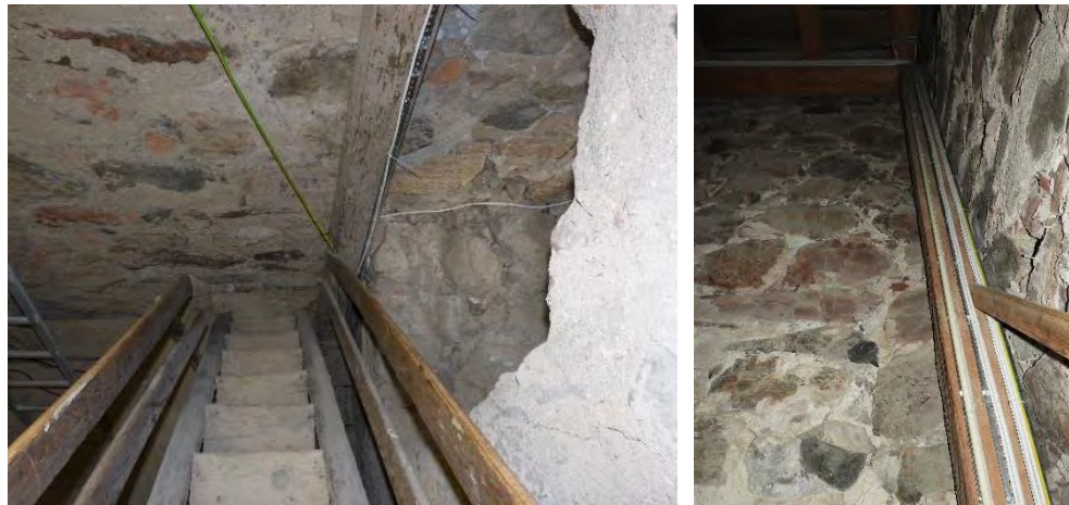
Figur 56. Eldragningar i torn gjordes på skenor som monterades på underlaget för att minska antalet fästpunkter.
