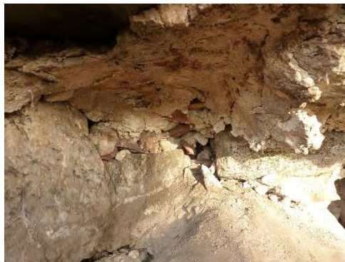
Figur 26. Ljust kalkbruk med stort inslag av flisor av röd sandsten i vapenbusets västra grundmur.
