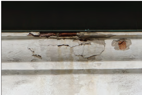
Figur 25. Skada i gesims till följd av läckage i takplåten.
