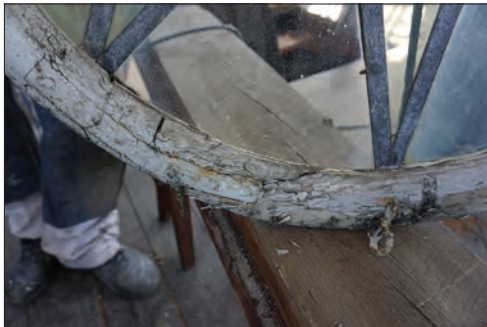
Figur 35. Detalj av ovalt blyspröjsad båge innan åtgärd.
