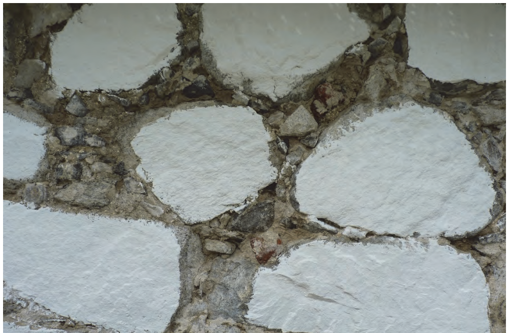
Figur 89. Östra fasaden, knackad fog samt kritade stenar. En stor mängd små skolstenar ligger mellan de större stenarna. Foto Helén Sjökvist.
