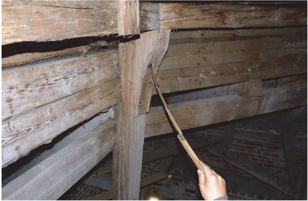
Figur 65. Konsol vid rötskadad bjälke inne i tornet under lanterninens bjälklag. Foto Helén Sjökvist.
