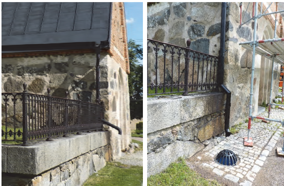
Figur 37. Tidigare stuprör med mjuka böjar och märkligt utformad utkastare vid vapenhusets sydvästra hörn. Foto Helén Sjökvist.
