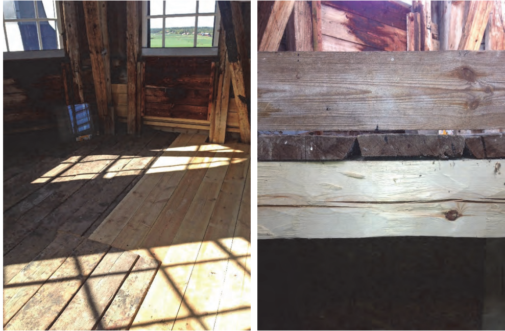
Figur 73. Av golvbrädorna är drygt hälften utbytta. Foto Johan Back, 3:12 byggnadsvård.
