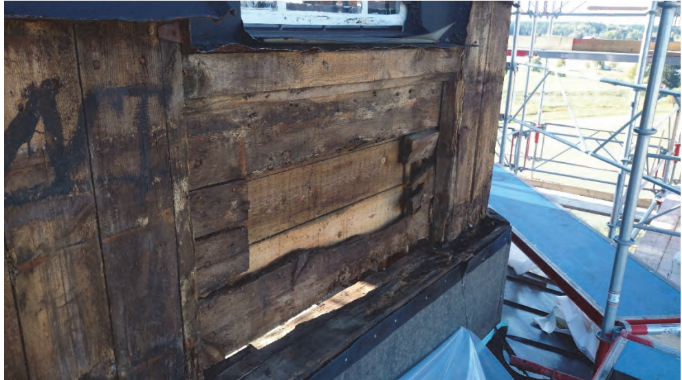
Figur 60. Rötskador under fönster i lanternin. Foto Aros plåt.
