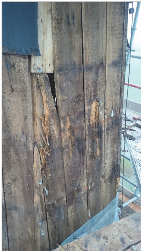
Figur 61. Rötskador i undertak, spira. Foto Aros plåt.
