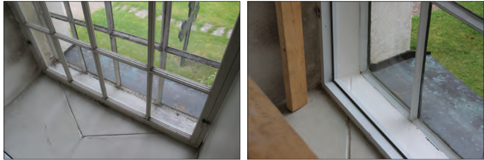
Figur 16. Vapenhusets södra fönster innan åtgärd.
