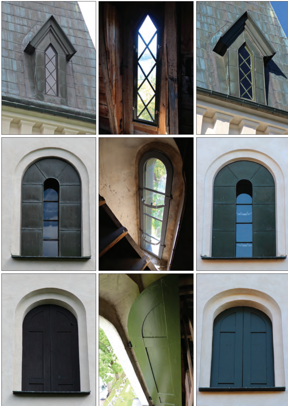
Figur 22 (överst, vänster). Tornfönster innan åtgärd.
