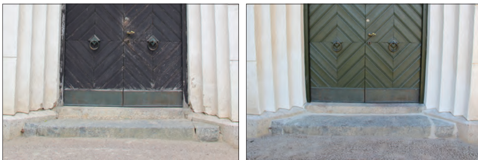
Figur 37. Trappan och putsen i västra portalens nedre del innan åtgärd.
