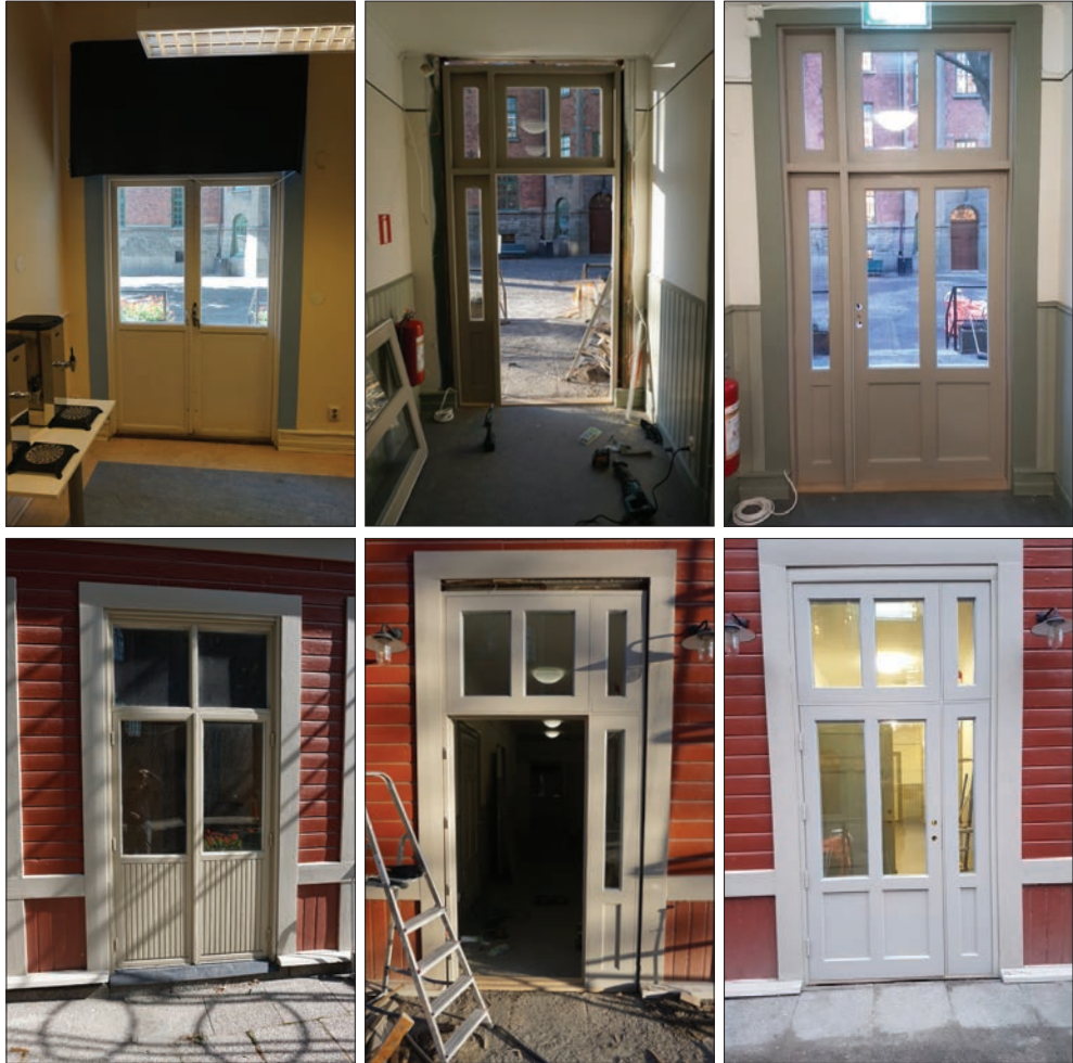
Figur 21 (överst, vänster). Verandadörren inifrån, innan åtgärd.
