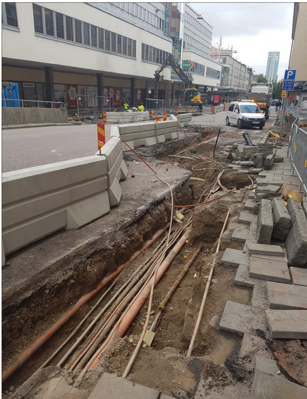
Figur 4. Schakt för el i södra delen av Stora Gatan. Foto från väster av Oskar Spjutb.
