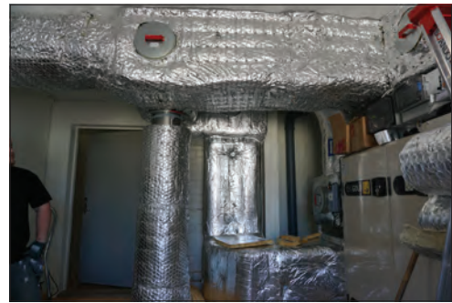
Figur 10. Ventilationsaggregatet och rördragning tar upp en betydande del av utrymmet i det nya rummet.
