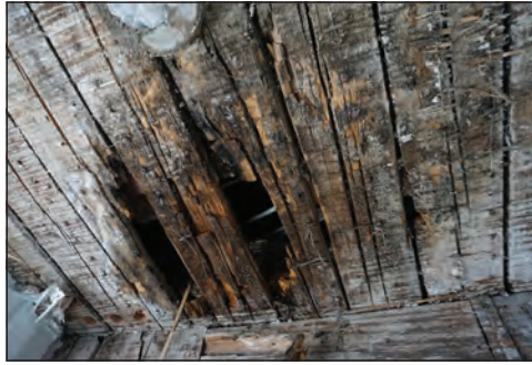
Figur 9. Röttskadans omfattning i undertak efter friläggning.
