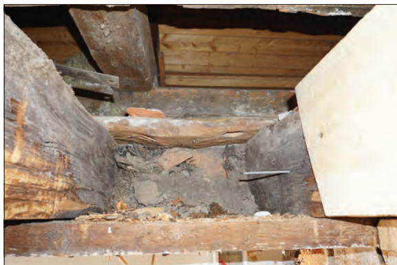
Figur 8. Foto taget mellan de två skadade bjälkarna, mot söder och takfot. På bilden syns rester av fyllningen och bjälklagets övre bräddtäckning samt blindbotten. Teglet är avlägsnat.
