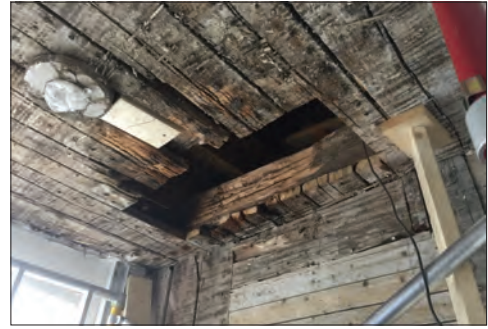
Figur 10. Röttskadade brädor kapade och avlägsnade. Foto Johannes Pennström (Roslagen Timmerhus AB).
