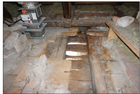
Figur 14. Det skadade området sett från vinden.
