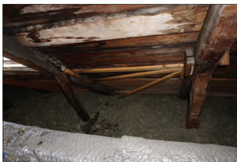
Figur 4. Längre ner har råsponten från 1986 rötskadats och släppt.
