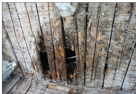
Figur 5. Rötskadans omfattning syns i takbrädorna i underliggande rum.
