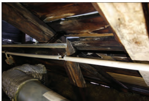
Figur 2. Pågående läckage i taket intill rötskadan. Dokumenterat i april 2017. Foto Lisa Skanser.
