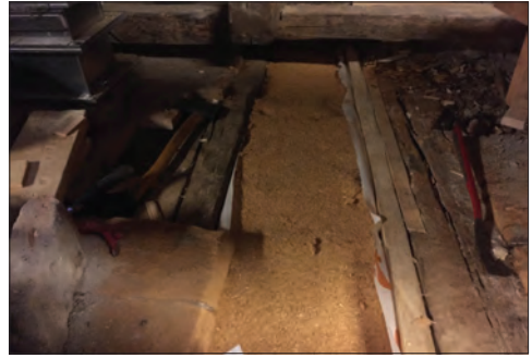
Figur 26. Facket mellan bjälkarna är fyllt med isolering, innan dess klätt med vindpapp. Foto Johannes Pennström.
