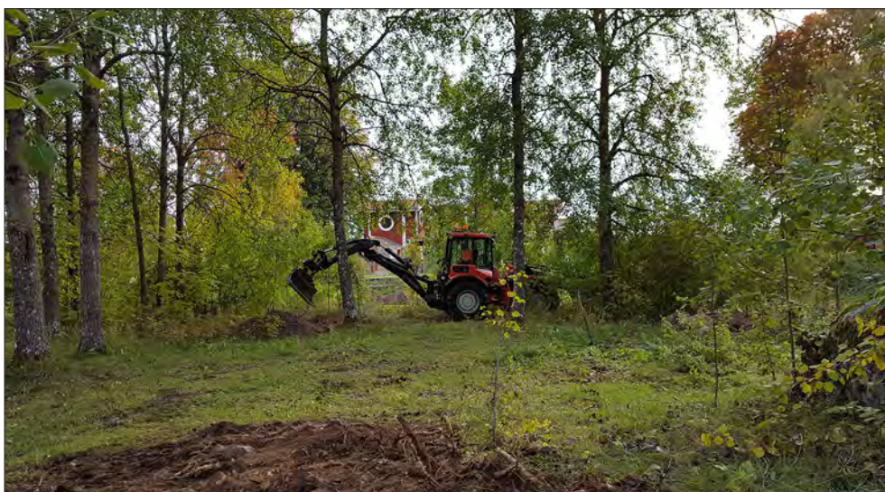
Figur 11. Schakt 3 återfylls. I förgrunden schakt 8, också igenlagt. Inom den öppna ytan mellan schakten grävdes schakt 9 och 10. Foto från väster.
