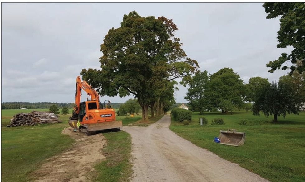
Figur 10. Del av schakt 2 vid Stenta, grävt med en kedjegrävare avsedd för kabelgrävning. Foto Reidar Magnusson.
