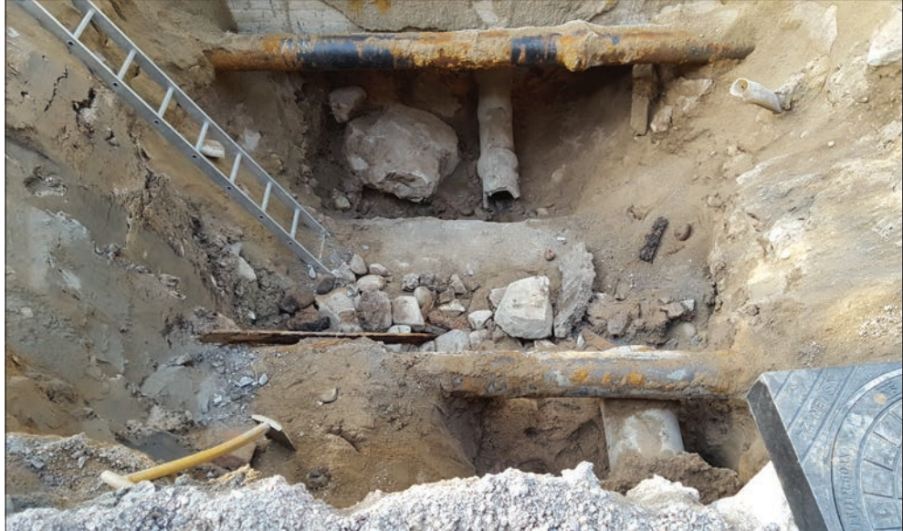
Figur 6. Schakt 2 sett från norr. Schaktet bestod av ett stort antal ledningar och moderna fyllnadsmassor. Foto Maud Emanuelsson.
