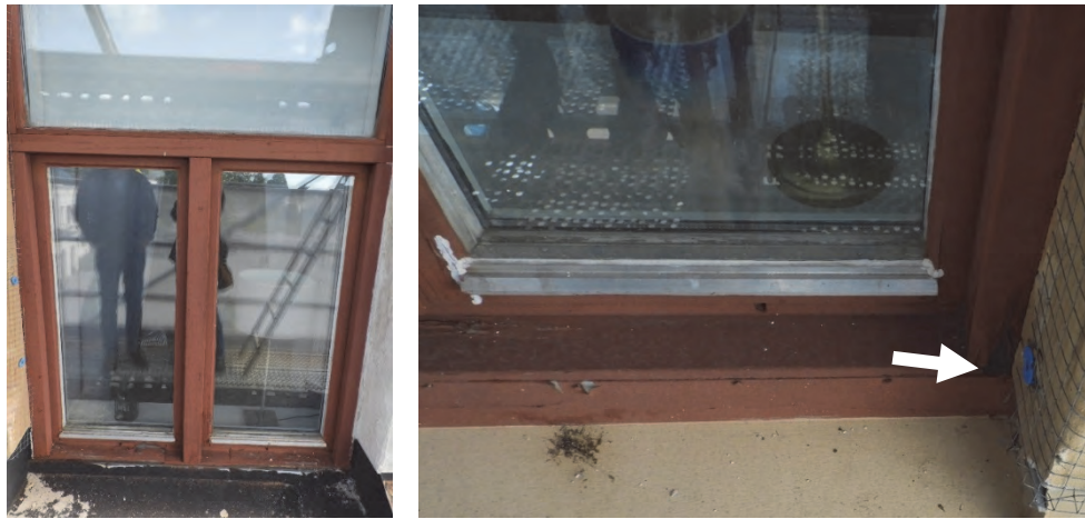
Figur 52. Fönstren i takkuporna byttes till inåtgående fönster 1984. Observera äldre lagningar i bottenstycket.
