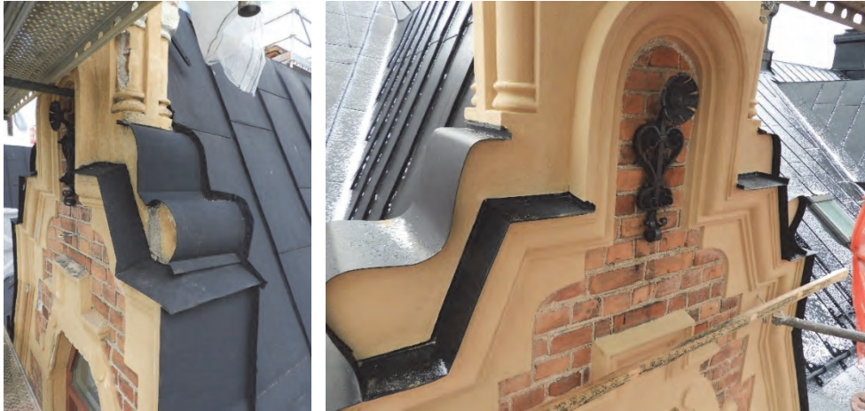
Figur 16. Avtäckning och putsdetaljer kring takkupa före åtgärder.
