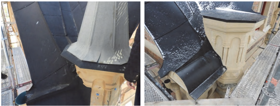
Figur 18. Plåtavtäckning vid turrell före åtgärder.
