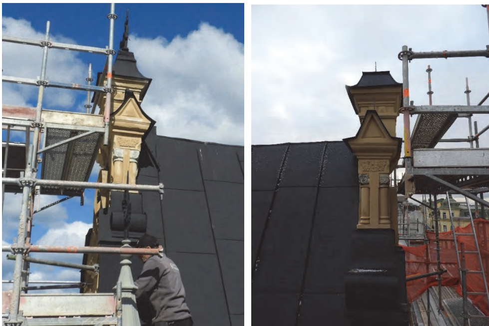
Figur 8. Avtäckning och putsdetaljer kring takkupa före åtgärder.
