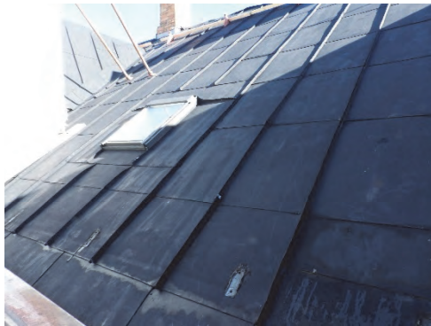
Figur 12. Takfall mot Barnbemsigatan före åtgärder.
