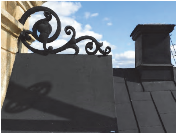
Figur 48. Utsmyckning av smide innan åtgärder.
