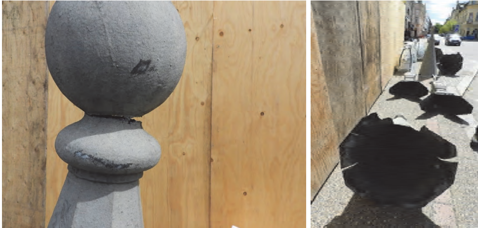
Figur 34. Zinken är mycket spröd och sprucken på flera ställen. Se spricka under kula. Figur 35. Samtliga zinkdetaljer är nedplockade för åtgärdande på verkstad.
