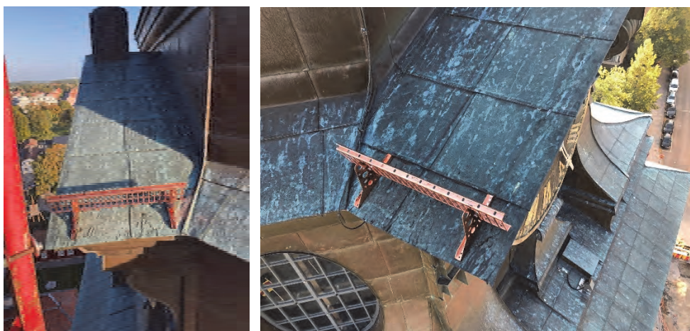
Figur 6. Iskratta på takfall ovan klocka, västra sidan. Foto: Västerås Byggplåt AB.
