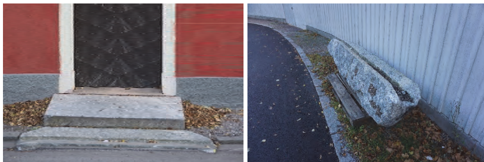
Figur 80. innan åtgärderna låg en stor stenränna placerad framför tröskelstenen vid huvudentrén.
