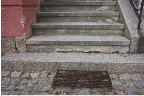
Figur 16. Skadade sättsteg i trappan.
