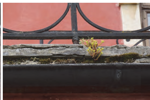
Figur 15. Bristfälligt tätskikt under kalkstensplattorna gör att fukt tränger igenom.
