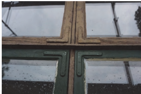
Figur 44. Fönster på biskopsgården före åtgärder.
