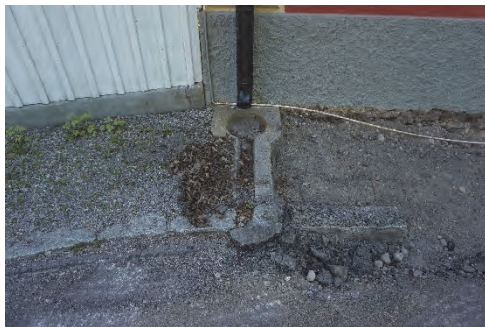
Figur 60. Vattenränna före åtgärder.
