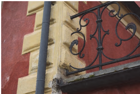
Figur 18. Putsbortfall på grund av fukt i fasaden.
