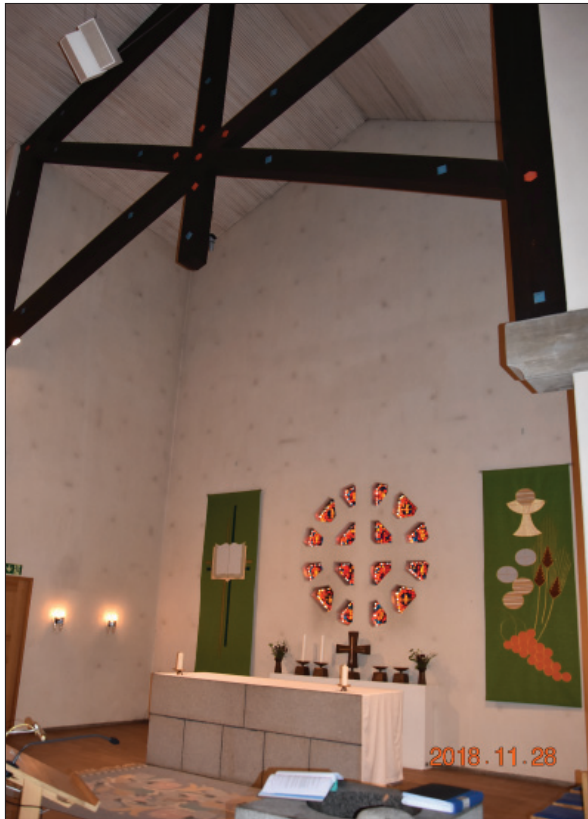
Figur 4. Mitt i bild altare och korfönster, se väggarnas smutsade ytor.
