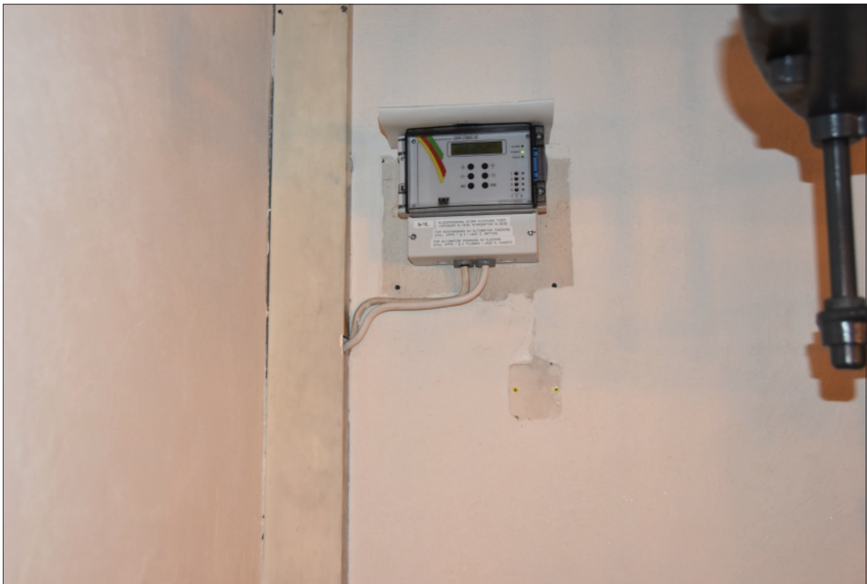
Figur 14. Ny elcentral på plats. Väggytorna runt centralen har åtgärdats efter slutbesiktning.
