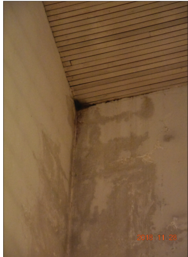
Figur 5. Detalj av fuktskada invid sidoläktare i kyrkans främsta del (södra sidan).
