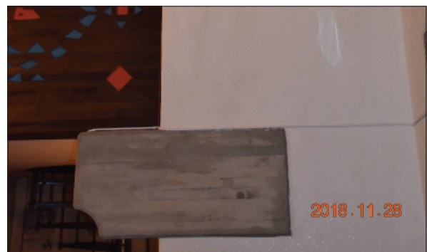
Figur 8. Detalj av sprickbildning på vänstra sidan av orgelläktaren.
