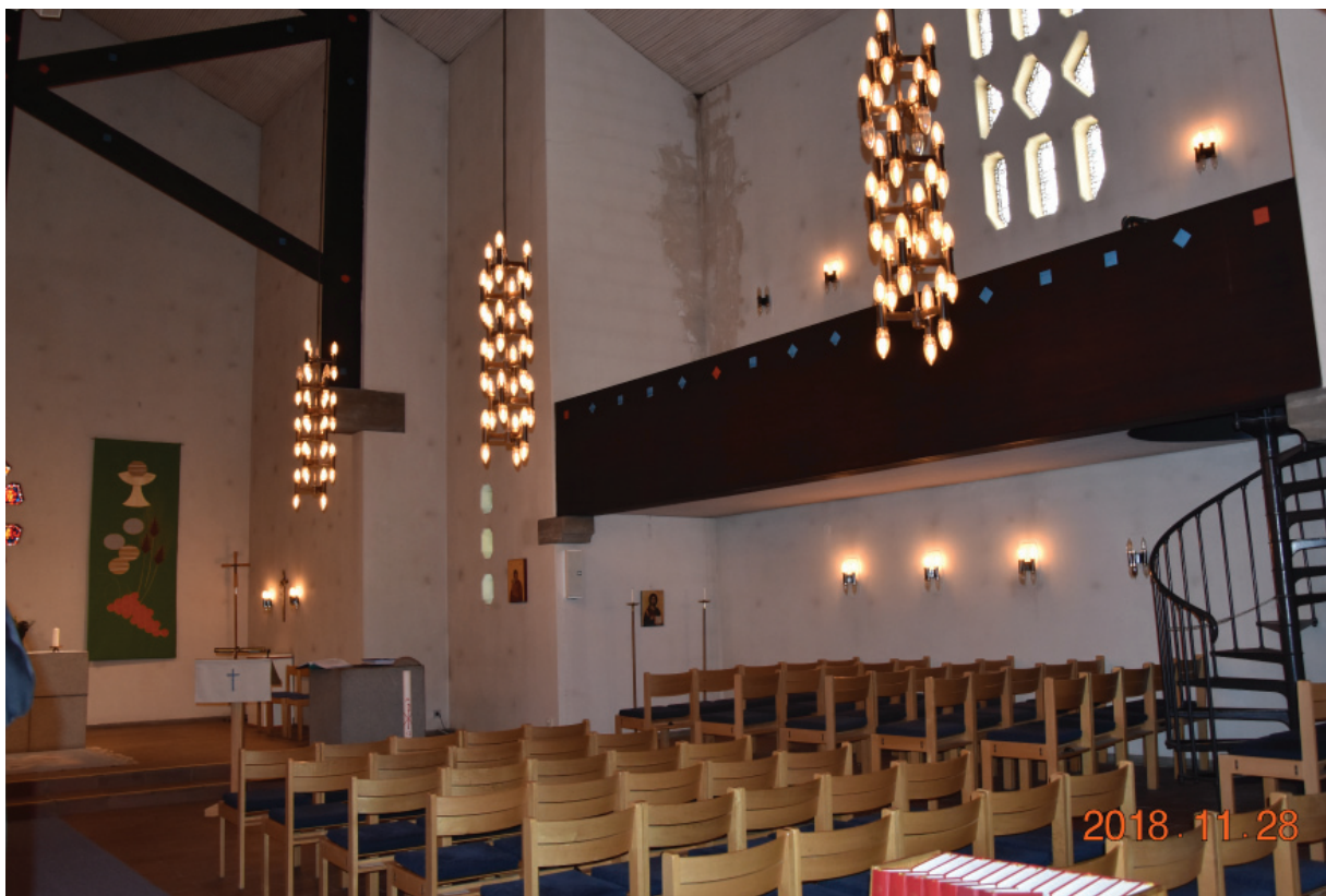
Figur 3. Utblick mot kyrkorummets södra del. Bakom fuktskadan i hörnet döljer sig ett inmurade stuprör, vilket är orsaken till skadan.
