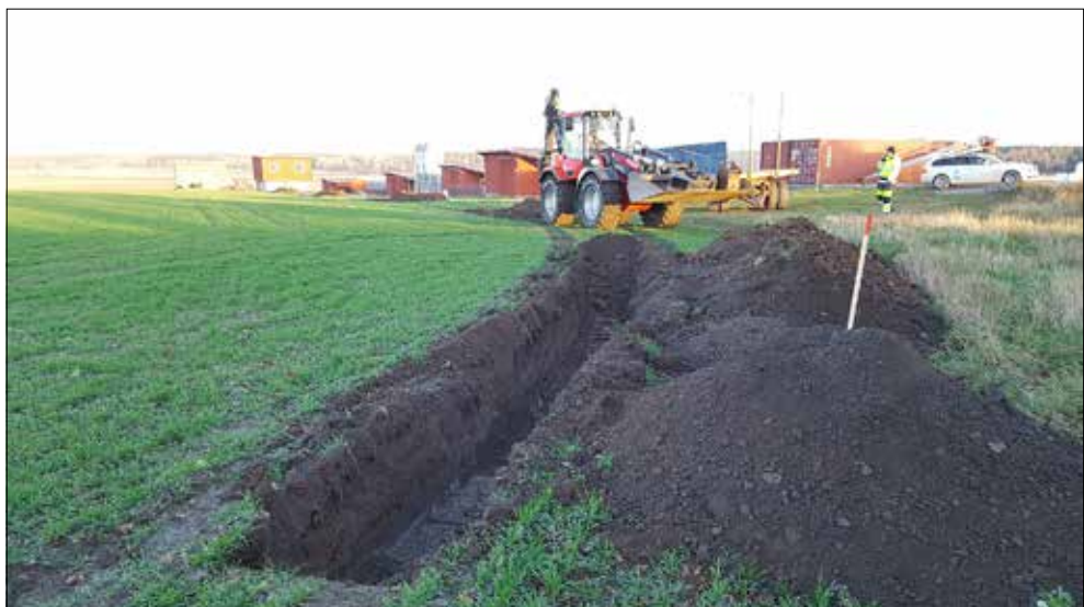
Figur 8. I ledningssträckans östra del grävdes kortare sökschakt. I förgrunden syns schakt 5. Foto från väster.
