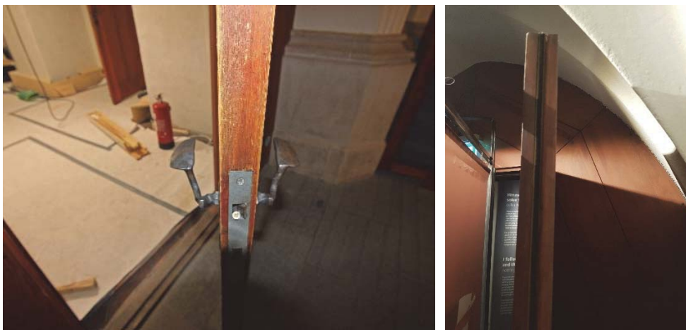
Figur 59. Dörrbladet sett från sidan före åtgärder.
