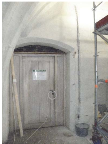
Figur 63. Spår efter tidigare inputsat elrör.
